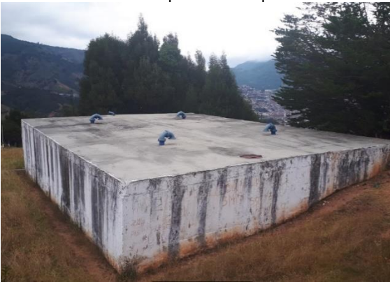
Tanque la Trinidad
