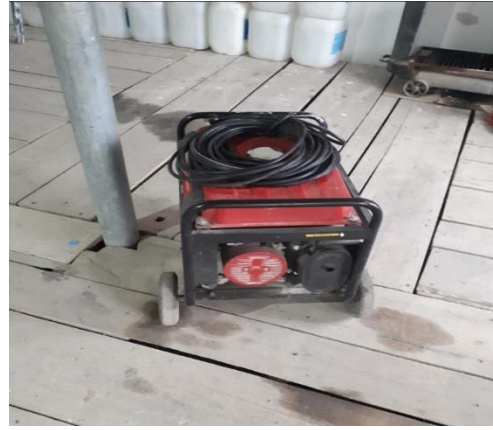
Planta eléctrica portátil.
