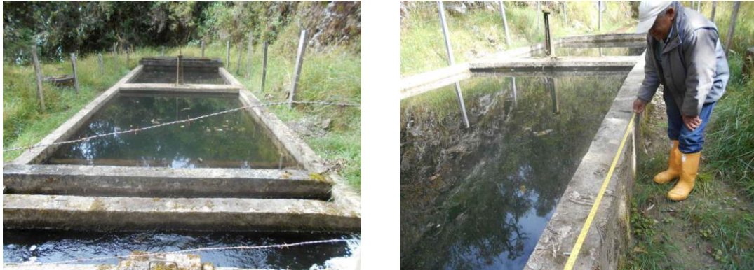
Imagen 13. Desarenadores El mono y Potreritos.
