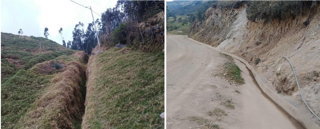
Imagen 65. Canales para aguas lluvias y escorrentía
