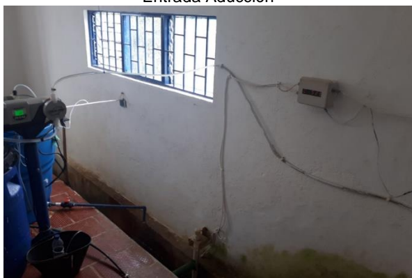
Dosificación PAC y medición de caudales.
