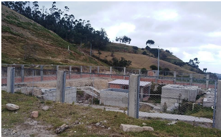
Imagen 64. Nueva Planta de tratamiento de lixiviados
