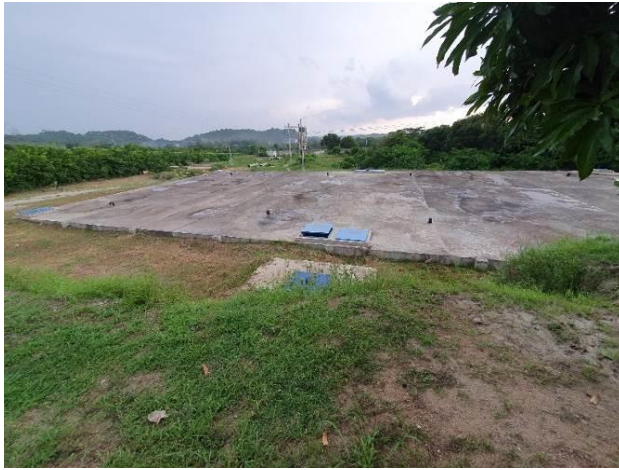
Tanques distribución Ciénaga
