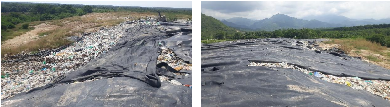
Imagen 62. Falta de cobertura de residuos en el vaso 1, traslape material sintético de cobertura
