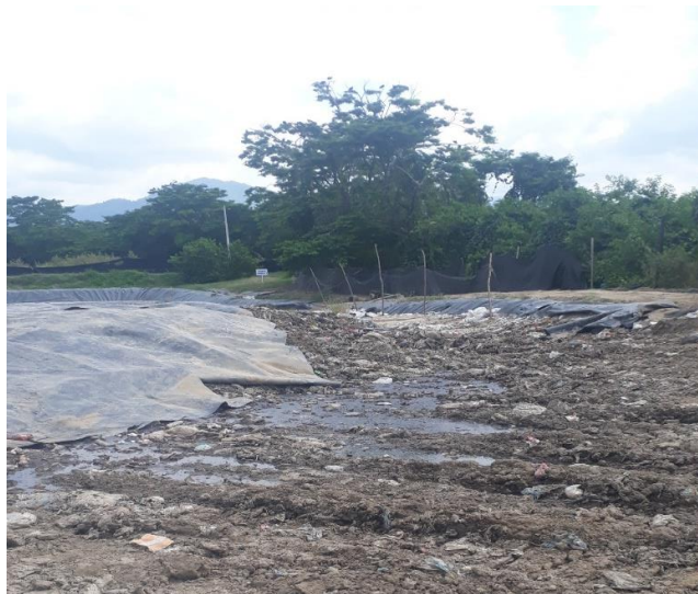
Imagen 64. Afloramiento de lixiviados costado sur occidental vaso 2
