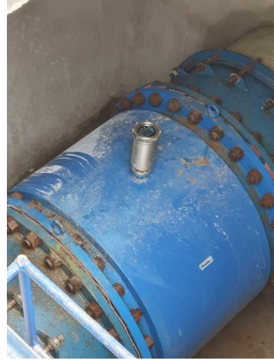
Macromedidor tubería de 36 pulgadas
