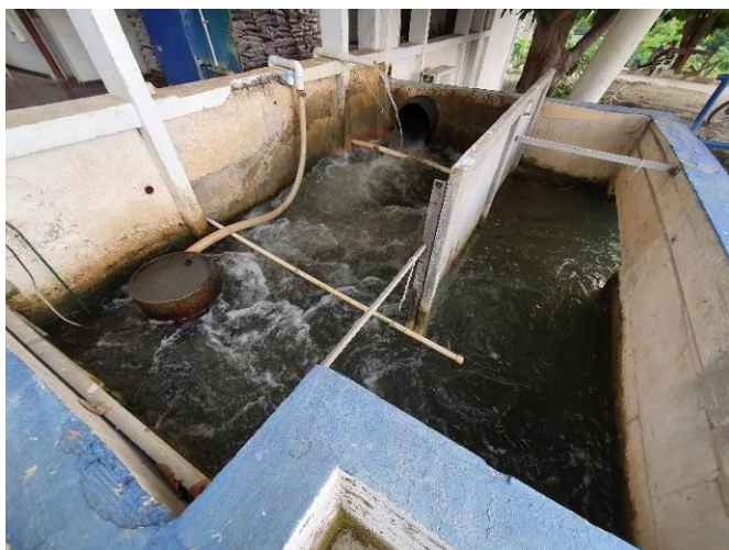
Cámara de entrada y adición de coagulante
