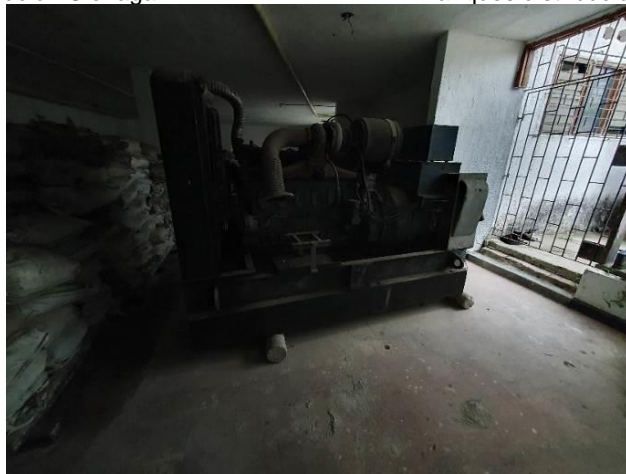
Planta de energía
