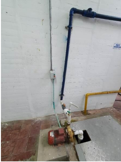
Adición de cloro
