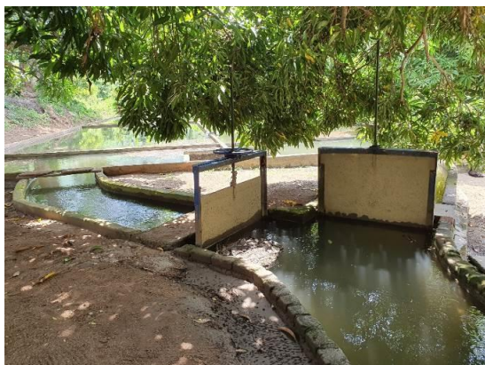
Entrada a desarenadores
