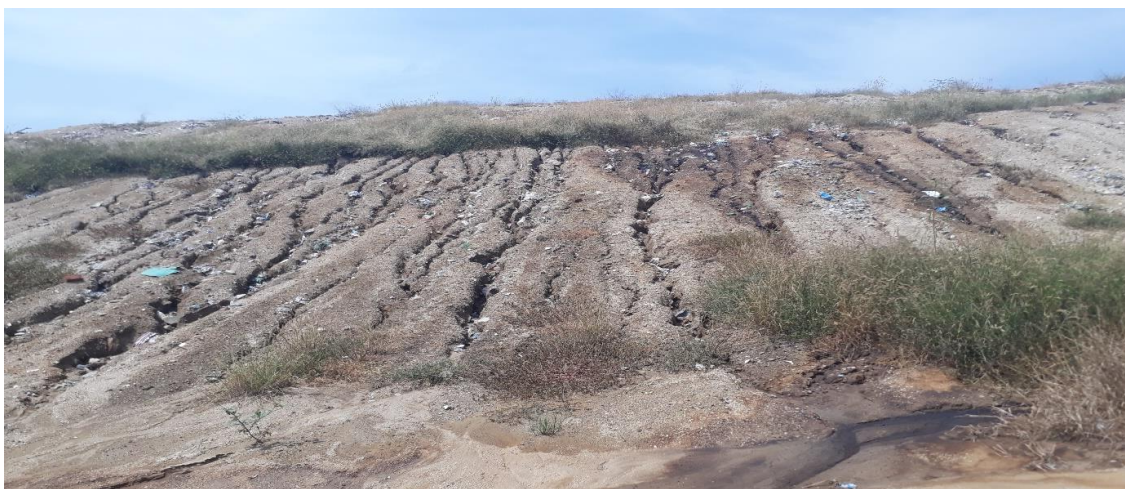
Imagen 68. Generación Cárcavas Vaso 1 Relleno Sanitario La María
