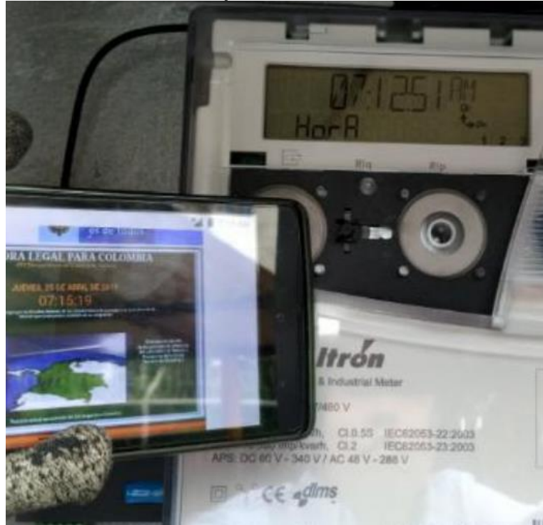
Ilustración 13. Falla por desfase horario del medidor
