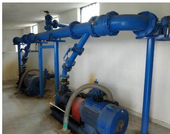
Sistema de bombeo con sistema de respaldo
