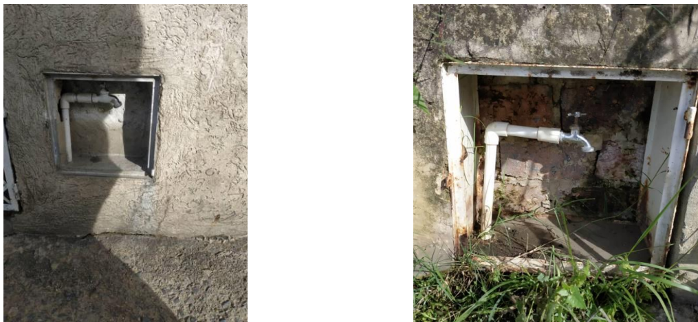
Puntos de muestreo existentes a renovar en la ciudad Fuente: Registro fotográfico SSPD – visita mayo de 2019
