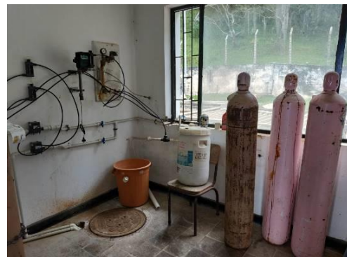
Cilindros de reserva para tratamiento y sistema de dosificación de cloro
