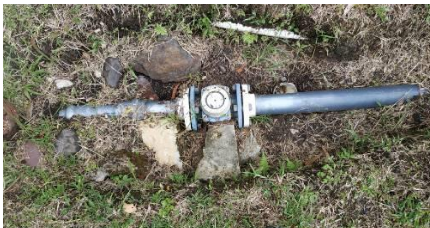
Imagen 16. Macromedidor existente a la salida de la planta de tratamiento
