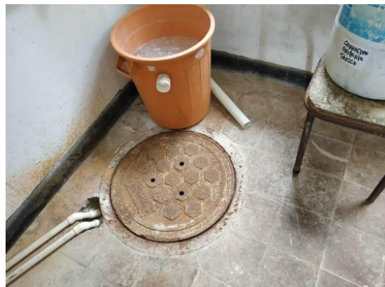
Tanque de Cloración
