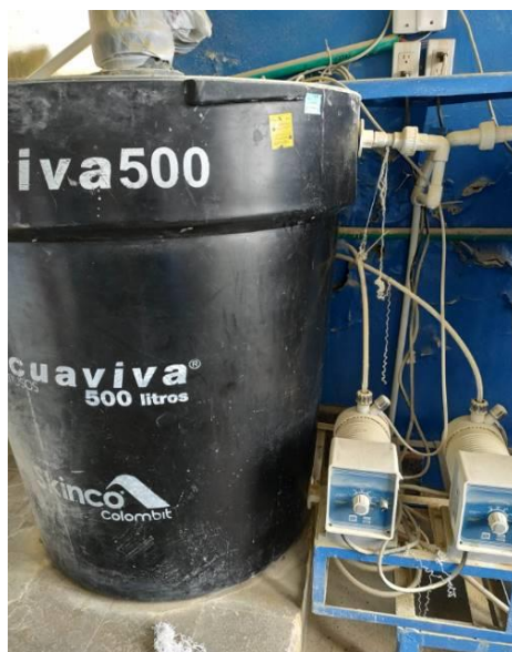
Sistema de Dosificación Hidroxicloruro de Aluminio – en desarrollo
