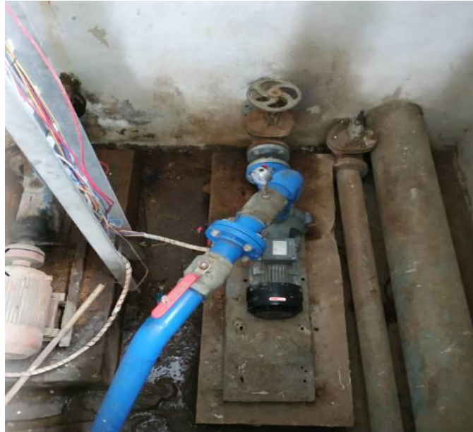
Imagen 13. Sistema de bombeo a la zona alta de la ciudad Barrio Kennedy.
