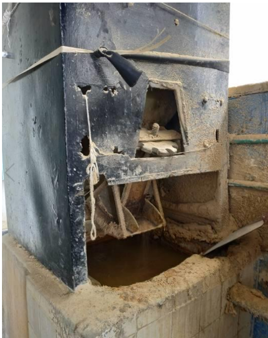
Tolva dosificadora de sulfato de aluminio
