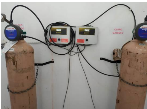
Sistema de dosificación de cloro gaseoso
