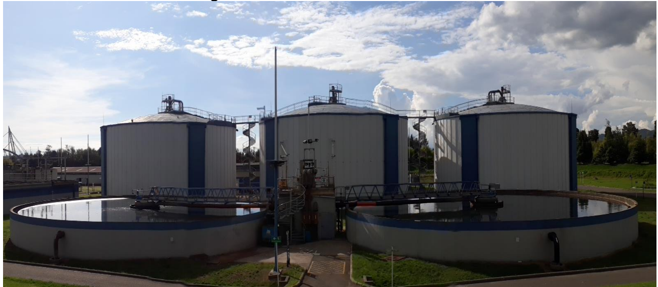
Espesadores y digestores
