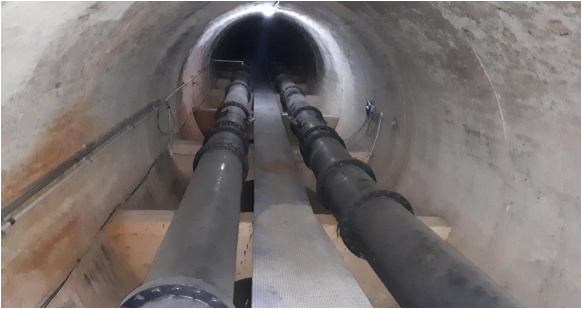
Tubería proveniente de captación de fondo
