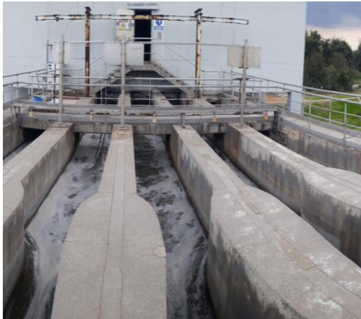
Canaletas Parshall de ingreso
