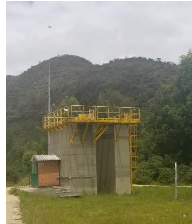
Estructura - válvula de salida de la PTAP
