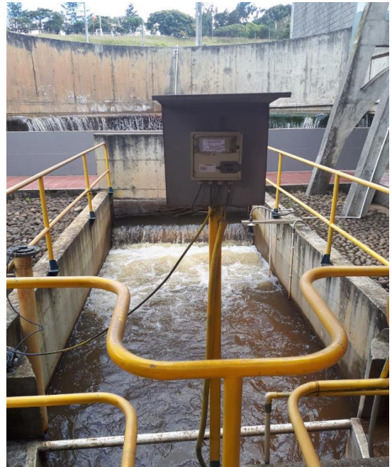
Control en entrada
