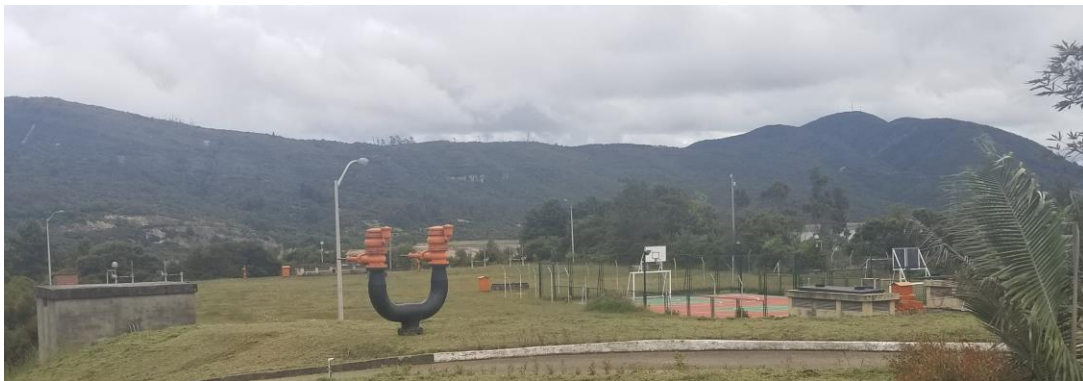
Tanque contacto de cloro
