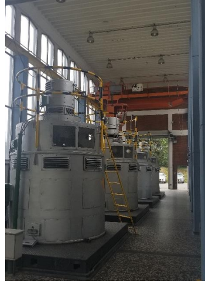
Unidades de bombeo Estación No.2.
