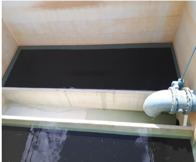
Mantenimiento de filtros
