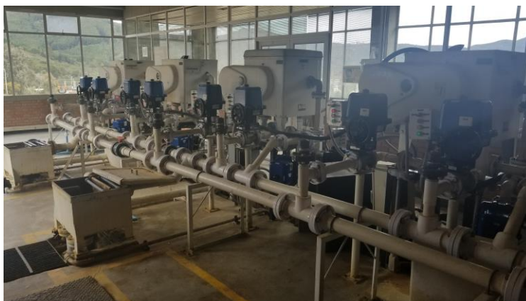
Dosificadores de sulfato
