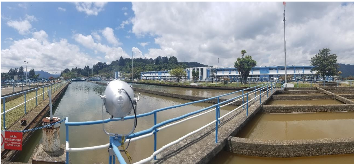
Paso del agua de los floculadores a los sedimentadores
