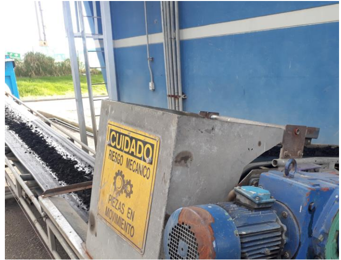
Banda transportadora lodo para disposición final
