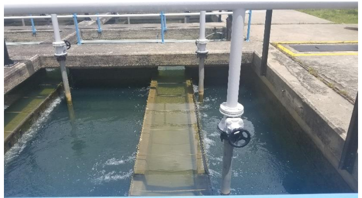
Unidad de filtración
