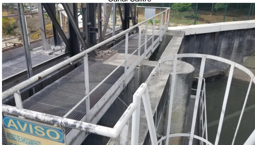
Compuerta de desvío
