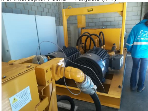
Estación de Bombeo de Aguas Residuales La Magdalena. Ubicada en el predio La Magdalena
