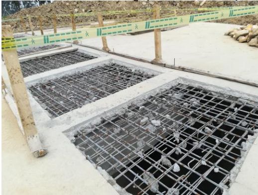
ITC 1 Pozo inicio Interceptor Tunjuelo – Canoas. Construcción de ventanas donde se ubicarán los bombes de aguas residuales al río Tunjuelo antes de la desembocadura del río Bogotá.
