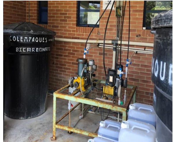
Dosificación de cloro
