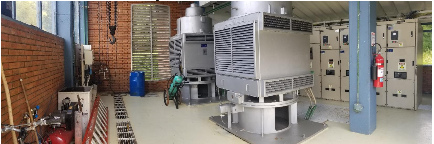
Estación de bombeo No. 4.
