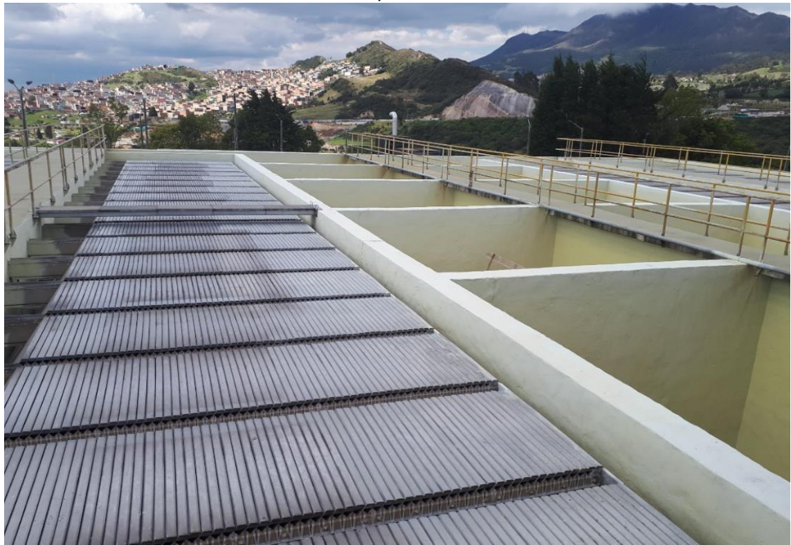
Floculadores y sedimentadores en mantenimiento.
