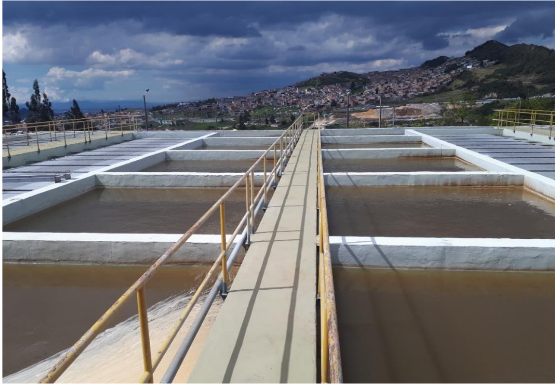
Floculación y sedimentación.
