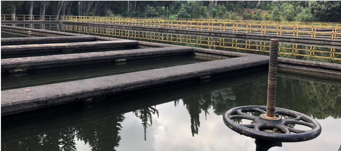
Sedimentadores y Floculadores
