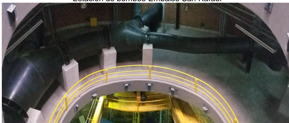
tubería de impulsión
