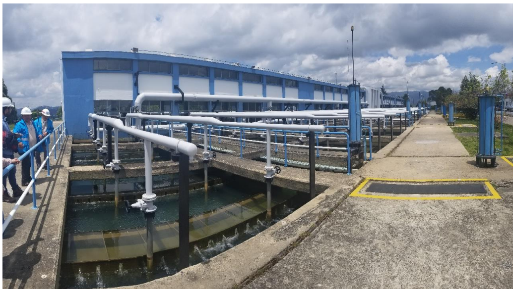
Sistema de filtración
