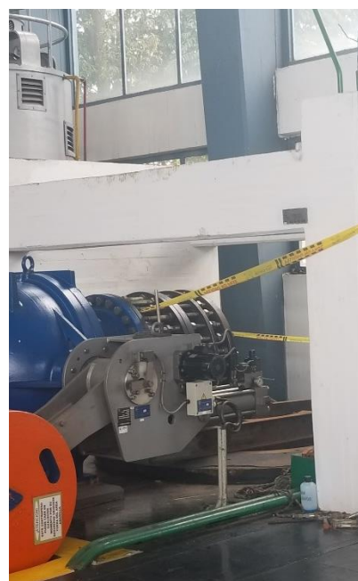
Espacio para la bomba en reparación
