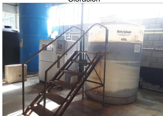
Tanque de sales
