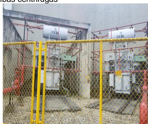
subestación de transformación
