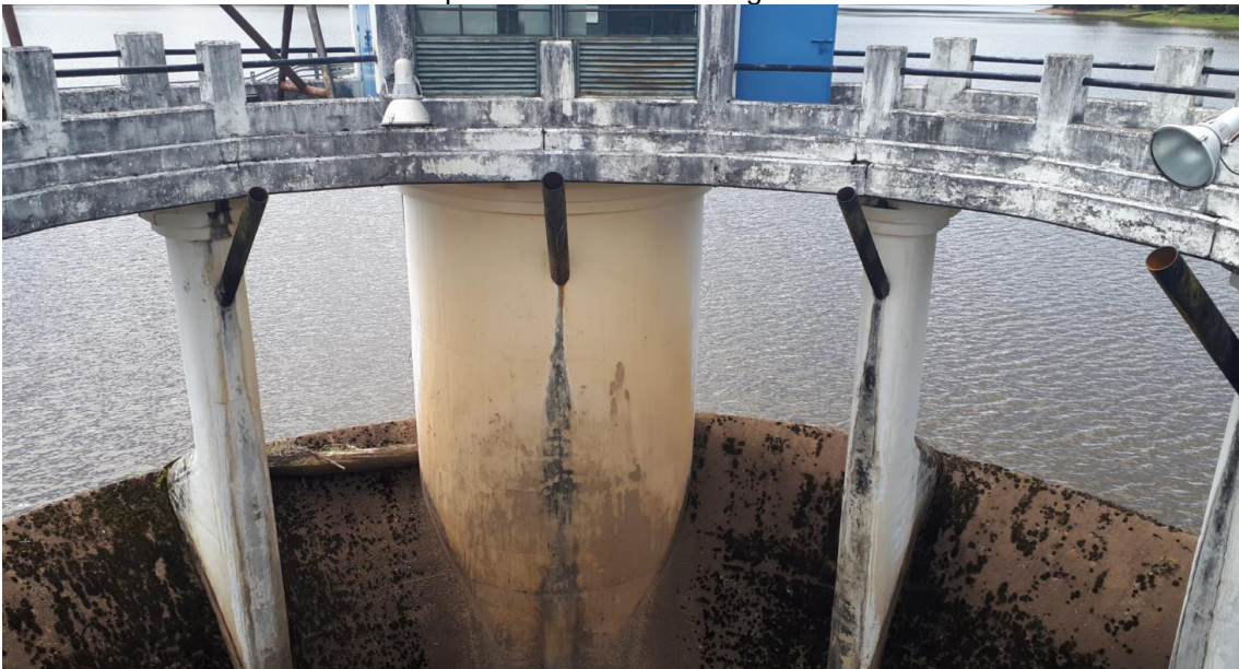
Estructura Morning Glory
