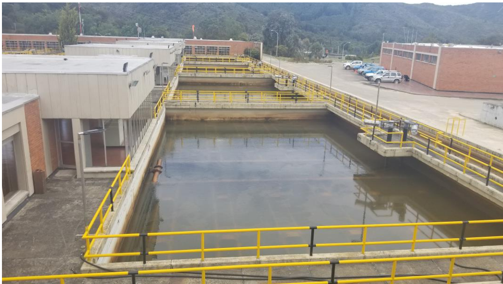
Línea 2 de Filtros
