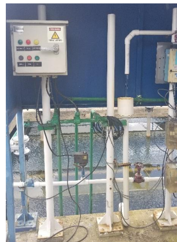
Medición en línea de calidad del agua filtrada
