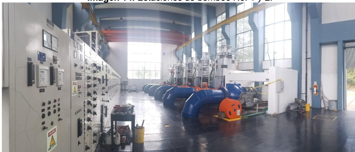
Estación de bombeo No. 1.
