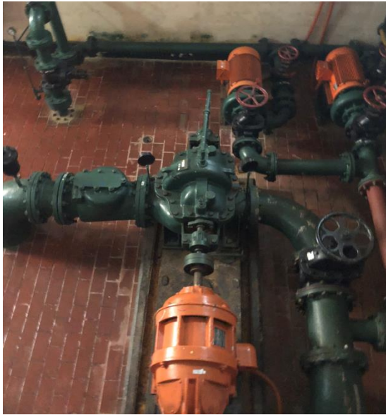
Sistema de Bombeo
