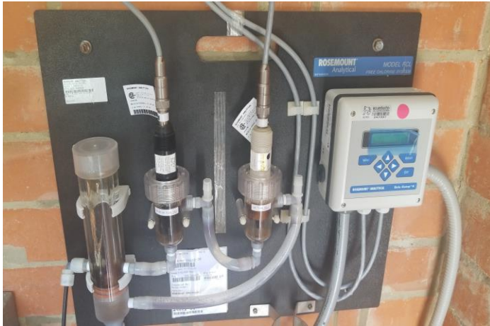
Medición parámetros en línea a la salida de la PTAP
