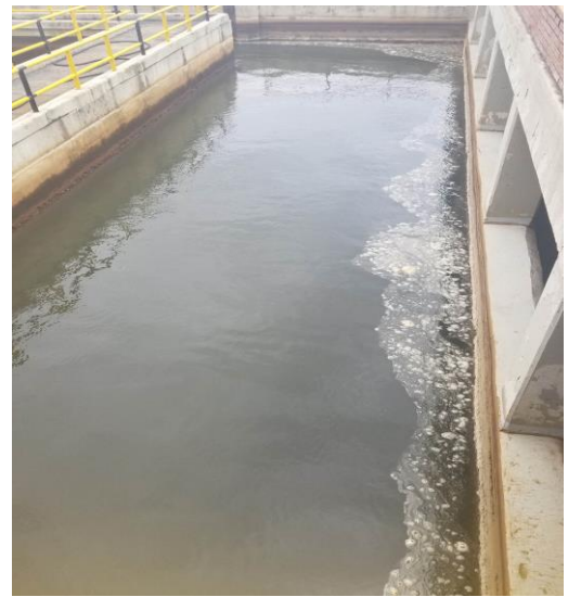
Canal de distribución a filtros
