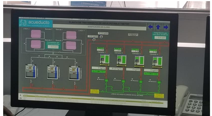
Pantalla de dosificación de cloro
