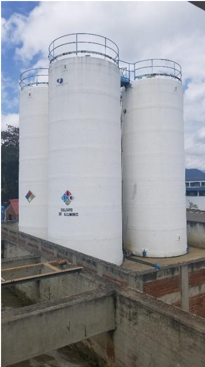
Tanques de sulfato de aluminio
