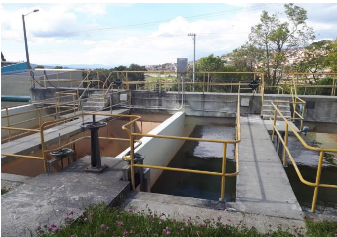
Tanques de ecualización
