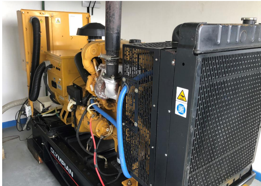
Planta de Energía alterna
