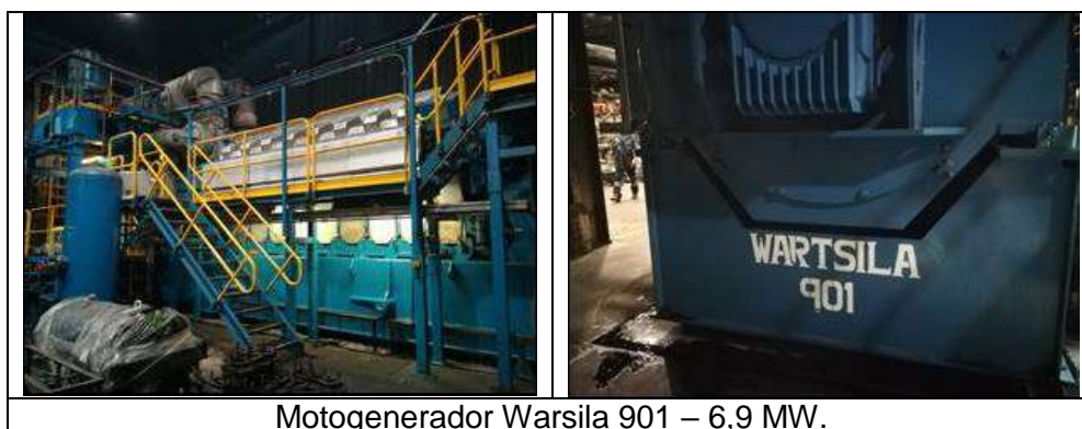
Imagen No. 6. Grupos electrógenos de la Casa de máquinas #1.
