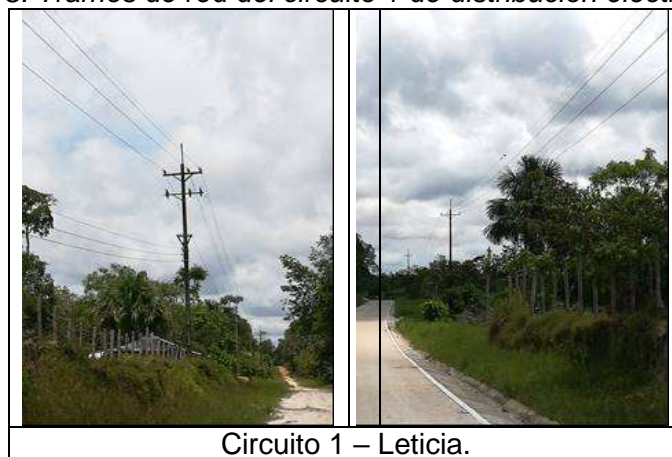
Imagen No. 8. Tramos de red del circuito 1 de distribución eléctrica de Leticia
