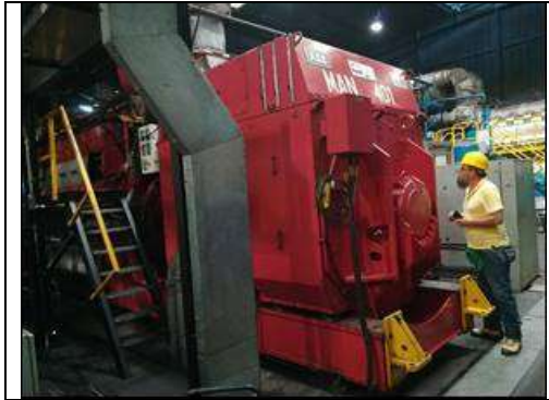
Motogenerador MAN 401 – 3,3 MW.
