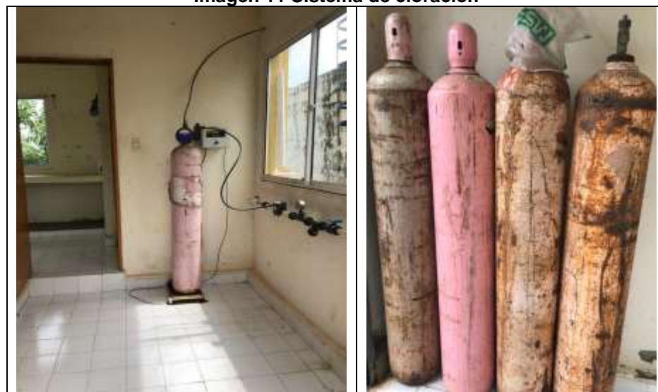
Imagen 11 Sistema de cloración
