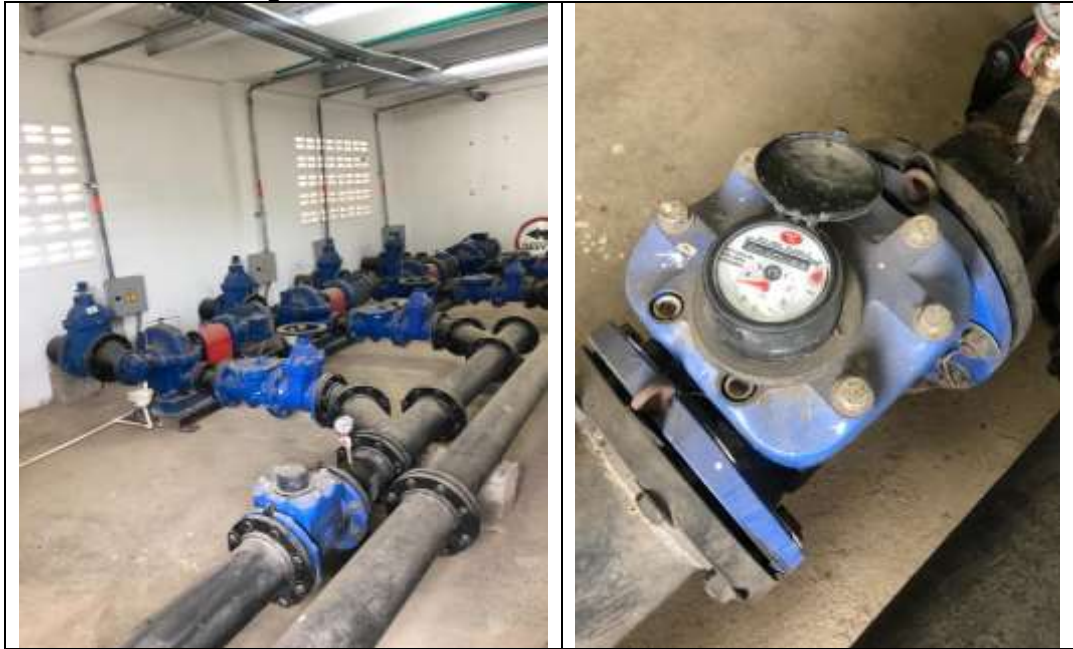
Imagen 12 Macromedidor fuera de funcionamiento
