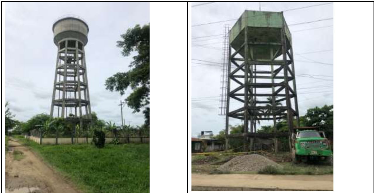
Imagen 13 Tanque elevado Barrio San José, capacidad 200 m 3 y Tanque elevado La Esmeralda, capacidad 400 m 3
