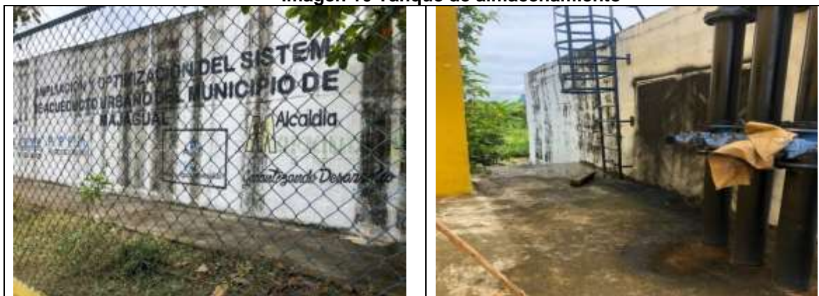
Imagen 10 Tanque de almacenamiento
