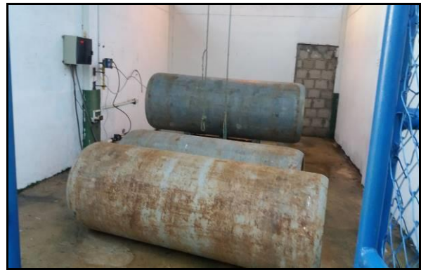
Dosificación Cloro gaseoso
