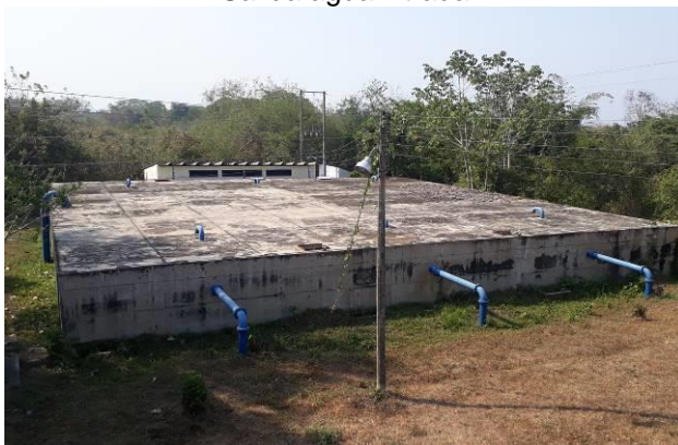
Tanque contacto de Cloro
