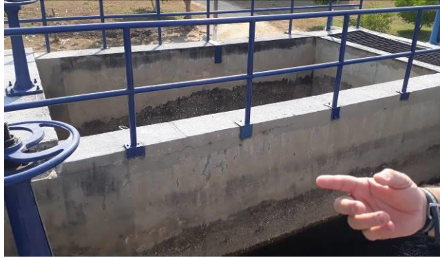
Estructura deteriorada de los filtros Fuente: Visita SSPD. febrero de 2019
