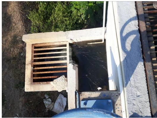
Salida agua filtrada
