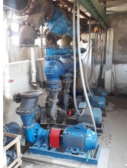
Bombas en paralelo
