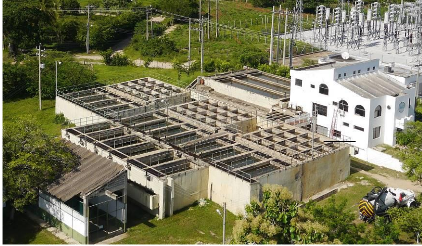
Vista general de la PTAP (Foto de AQUAMAG SA ESP)
