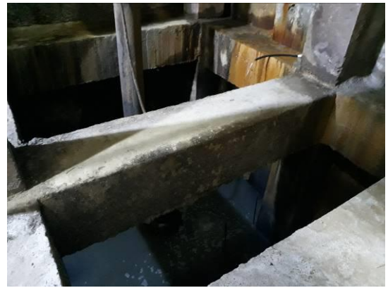
Tanque de bombeo
