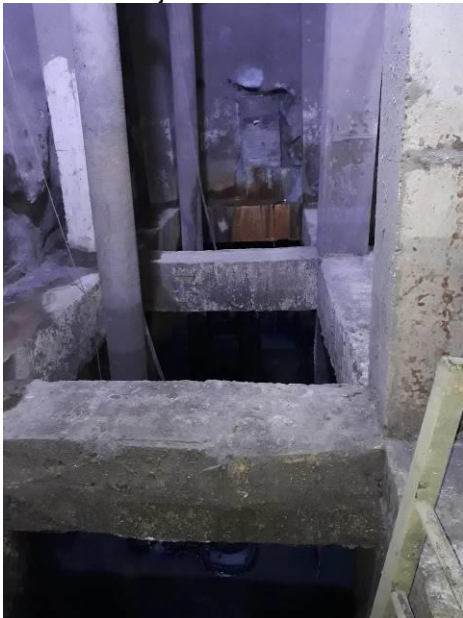
Vista superior tanque de almacenamiento
