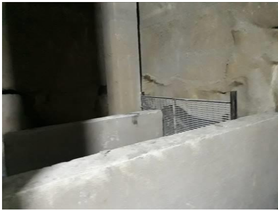
Rejillas de cribado
