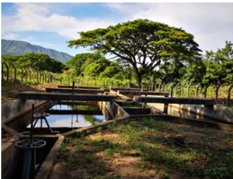
Imagen 21. Aducción y desarenador
