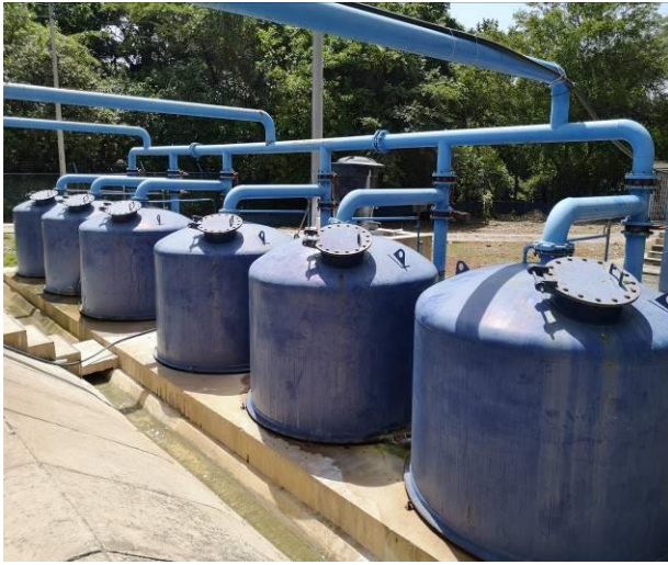
Batería de Filtración
