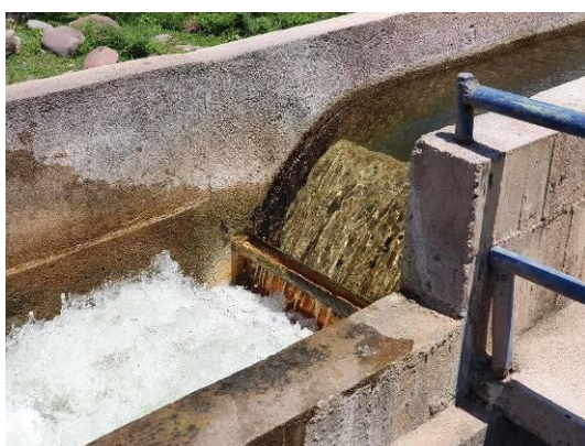
Aplicación de coagulante y mezcla rápida
