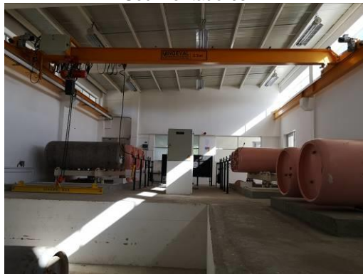
Tanques de cloración
