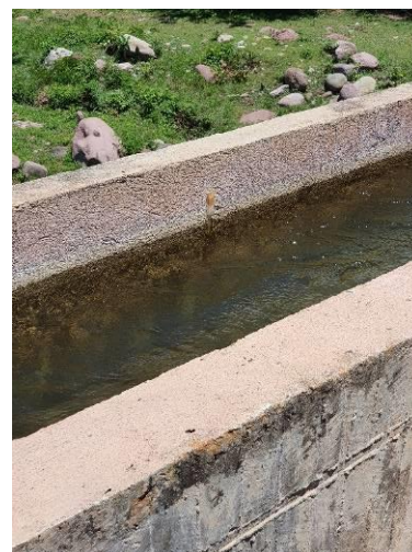
Regleta para la medición del caudal de entrada
