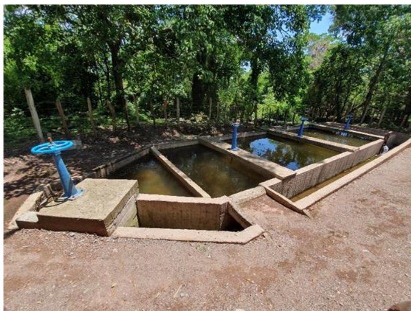
Imagen 38. Desarenador del sistema de captación antiguo.
