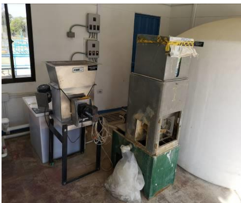
Dosificación de sulfato
