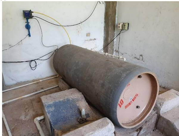
Tanque de cloro gaseoso
