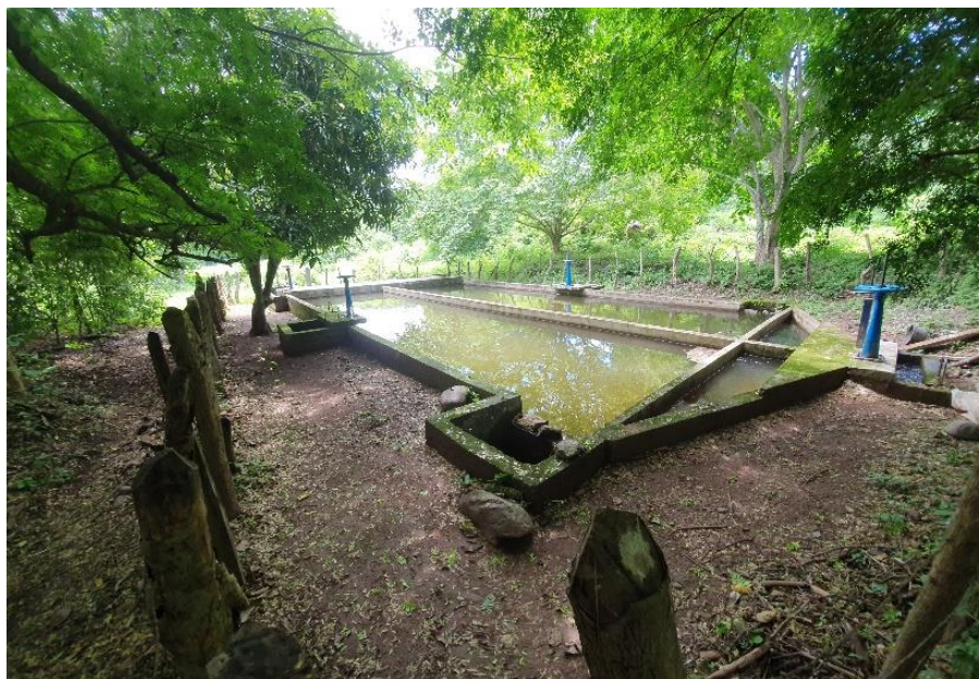
Imagen 40. Desarenador del sistema de captación nuevo.
