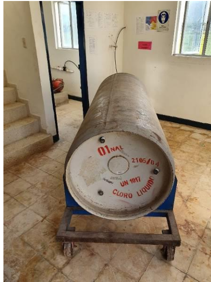
Tanque de cloro gaseoso
