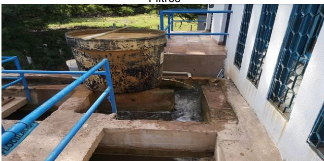
Tanque de dosificación
