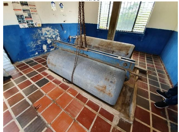
Tanque de cloro gaseoso
