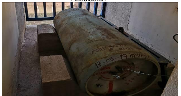
Tanque de cloración
