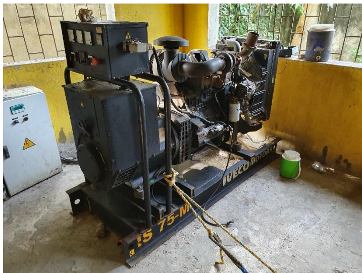
Planta de emergencia
