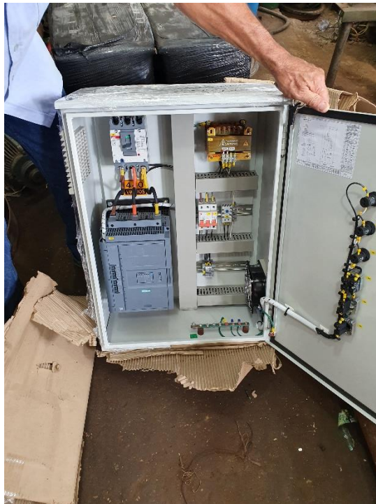
Nuevo tablero de control
