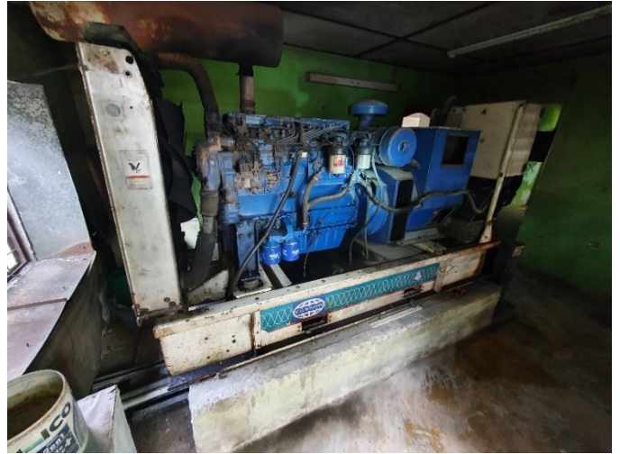
Planta de emergencia
