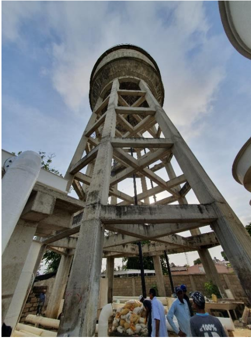
Tanque elevado zona sur
