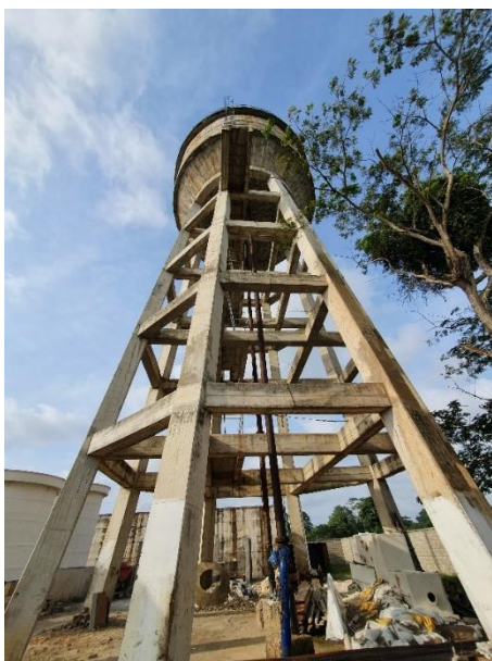
Tanque elevado zona norte
