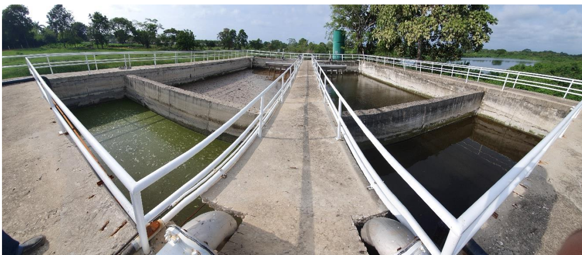
Reactores de aireación
