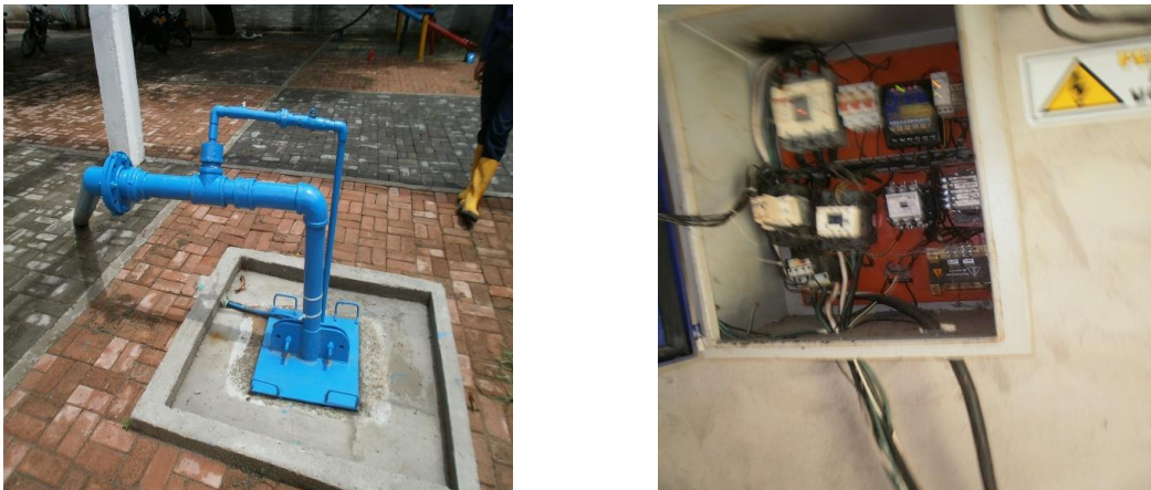
Imagen 6. Pozo barrio Centro
