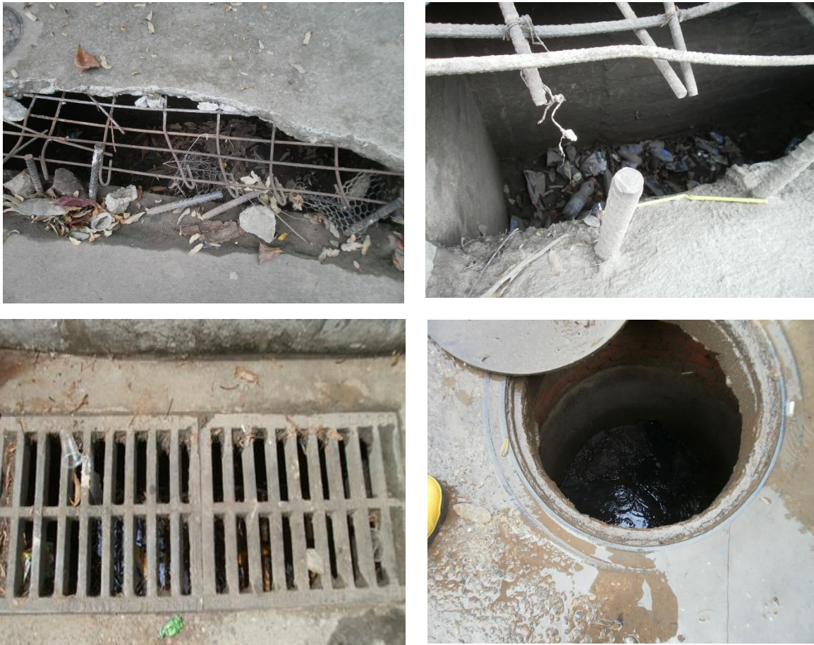
Imagen 23. Colectores de aguas lluvias
