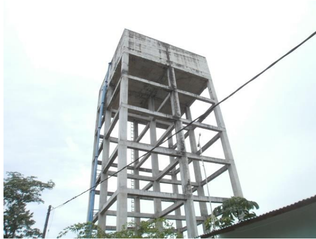
Imagen 14. Tanque de almacenamiento
