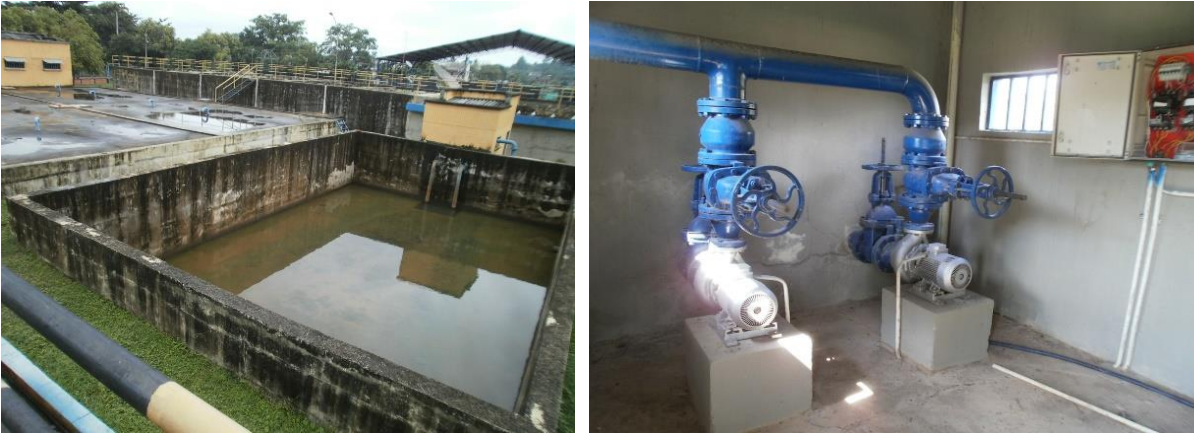
Imagen 17. Tanque de Retro lavado
