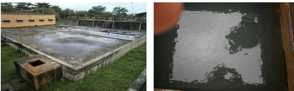
Imagen 13. Tanques de almacenamiento
