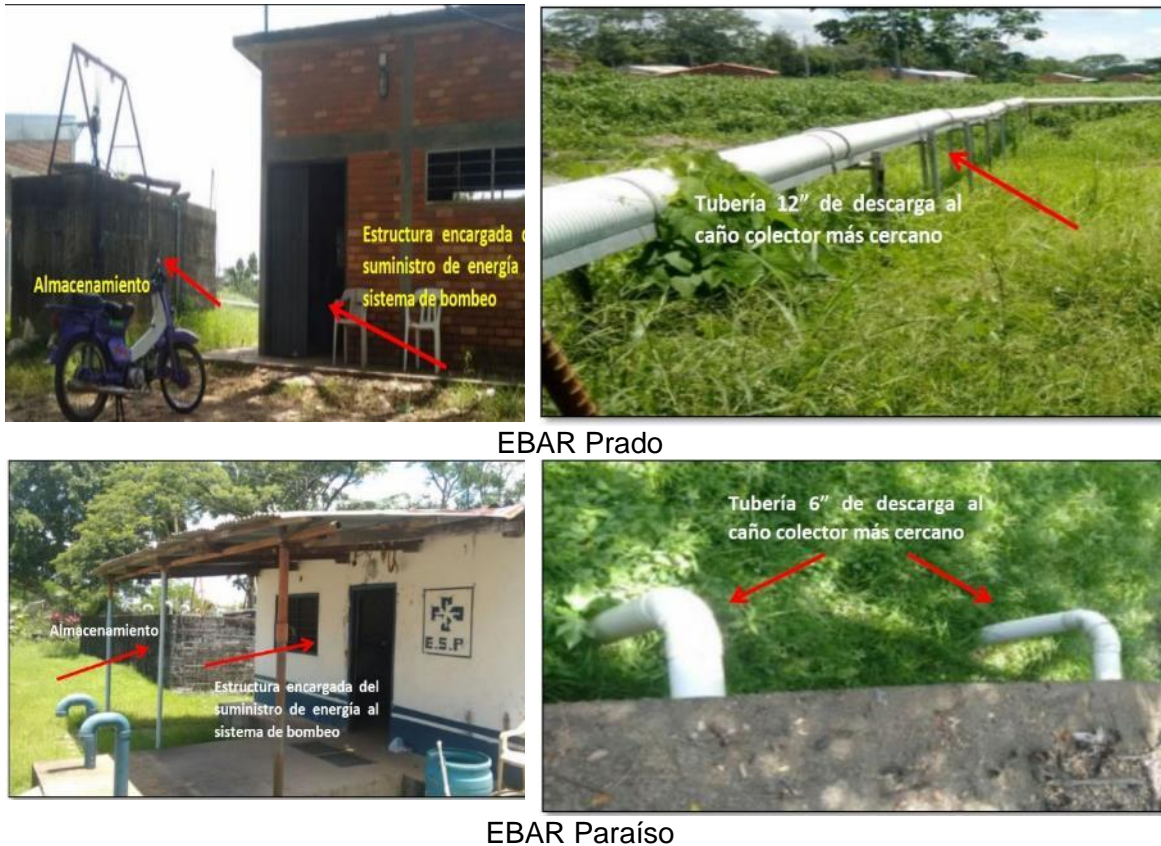
Imagen 20. Estaciones de bombeo de agua residual Yondó
