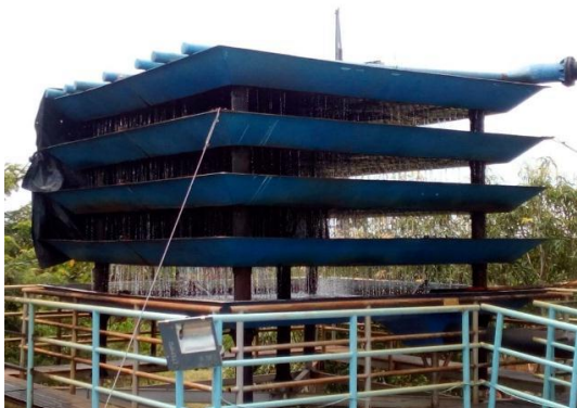
Torre de aireación
