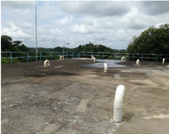
Tanque de almacenamiento
