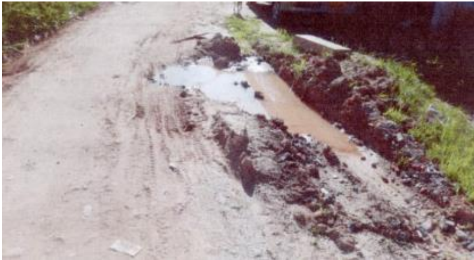
Imagen 31. Estado de la Calle 47A con Carrera 65 posterior al arreglo de tubería
