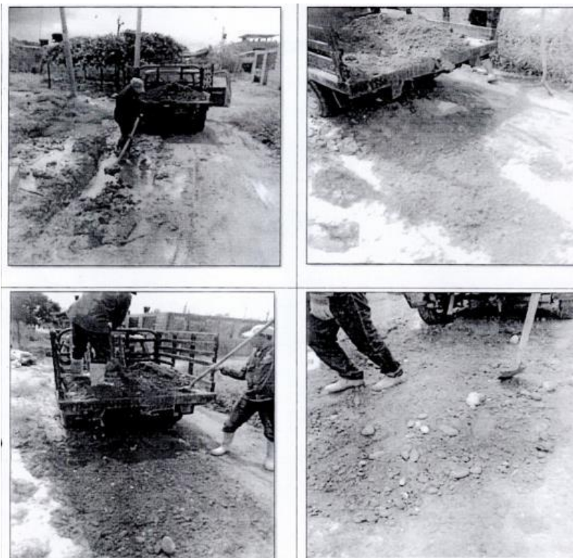
Imagen 32. Reparación de la tubería en la Calle 47A con carrera 65 de Yondó.
