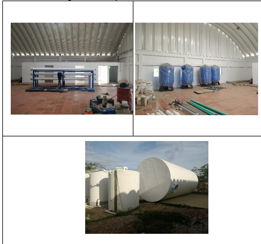
Imagen 6 Nueva planta de osmosis inversa
