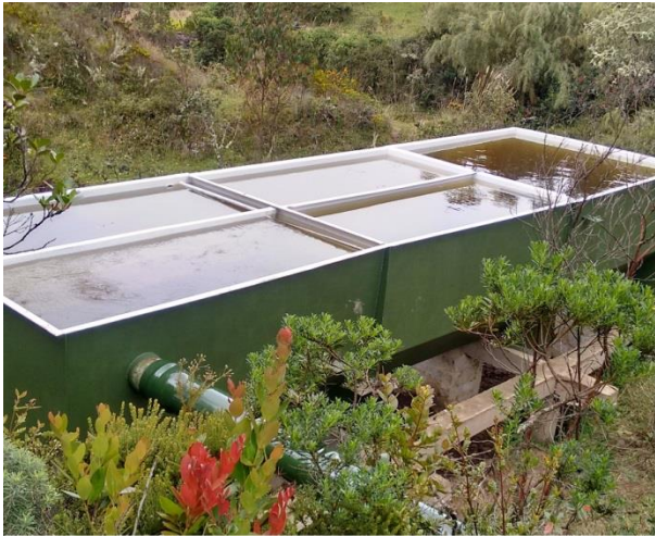
Imagen 13. Características Desarenador ubicado en la Bocatoma
