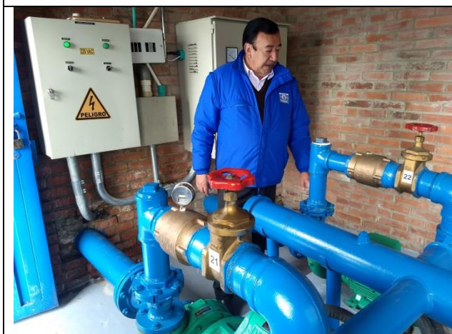
Imagen 21. Sistema de bombeo ubicado en las instalaciones de la PTAP nueva
