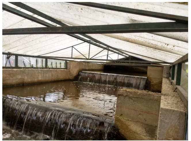
Imagen 16. Características Desarenador entrada a la PTAP
