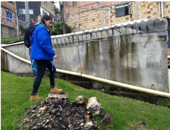
Imagen 15. Características Desarenador entrada a la PTAP
