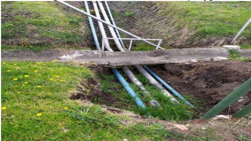
Imagen No. 4. Tuberías de conducción de GLP líquido y gaseoso
