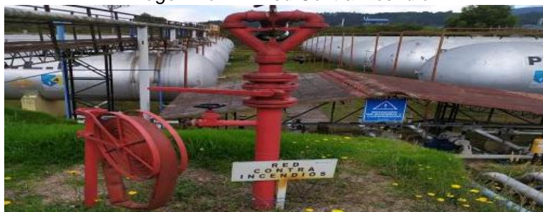
Imagen No. 11. Red Contra incendio
