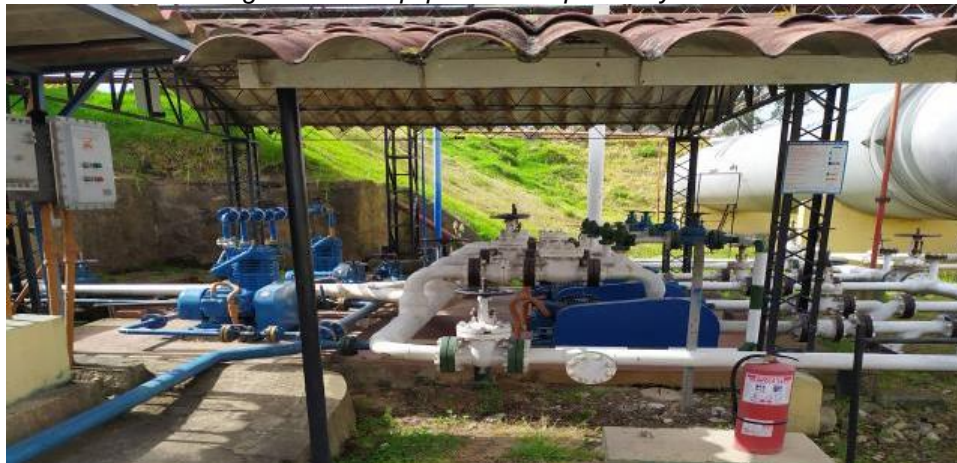
Imagen No. 6. Equipos de compresión y bombeo
