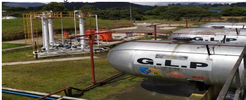
Imagen No. 12. Sistema de filtrado de GLP
