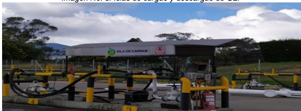
Imagen No. 3. Islas de cargue y descargue de GLP
