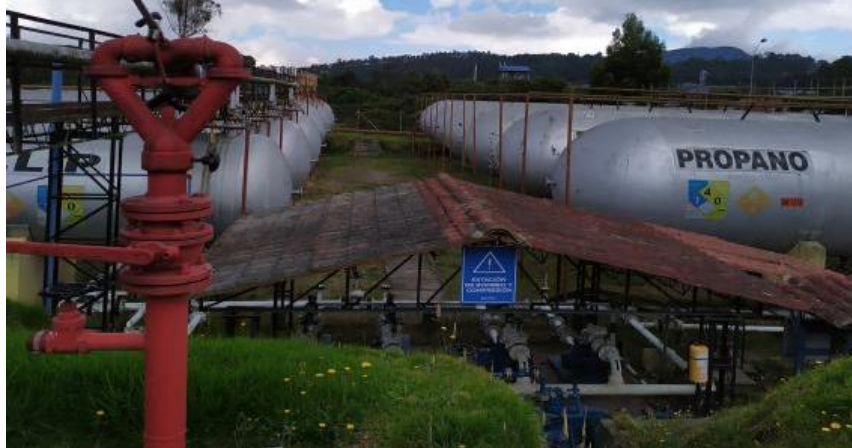
Imagen No. 5. Estación de compresión y bombeo de GLP
