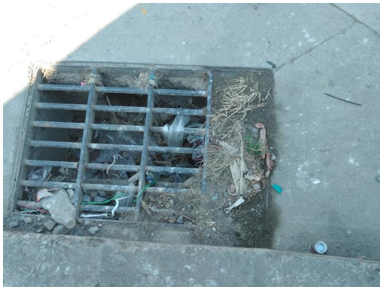
Imagen 44. Sumidero. Fuente: Visita SSPD, 2018.
