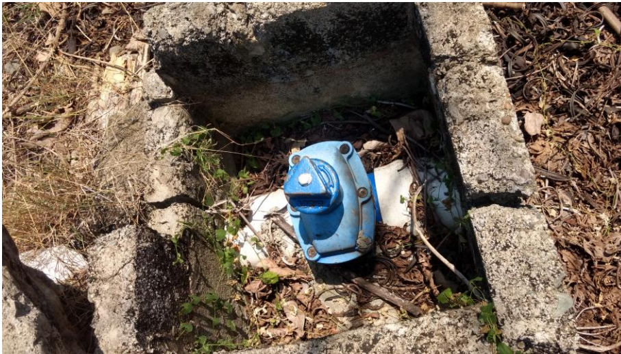
Imagen 30 Válvula ubicada en la entrada del tanque de almacenamiento. Fuente: Visita SSPD, 2018.
