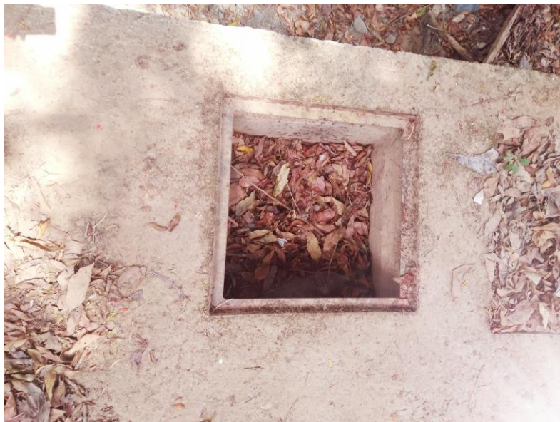
Imagen 20. Tanque Colmatado Fuente: Visita SSPD, 2018.
