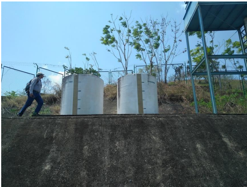
Imagen 24. Tanques de 5000 L, PTAP. Fuente: Visita SSPD, 2018.
