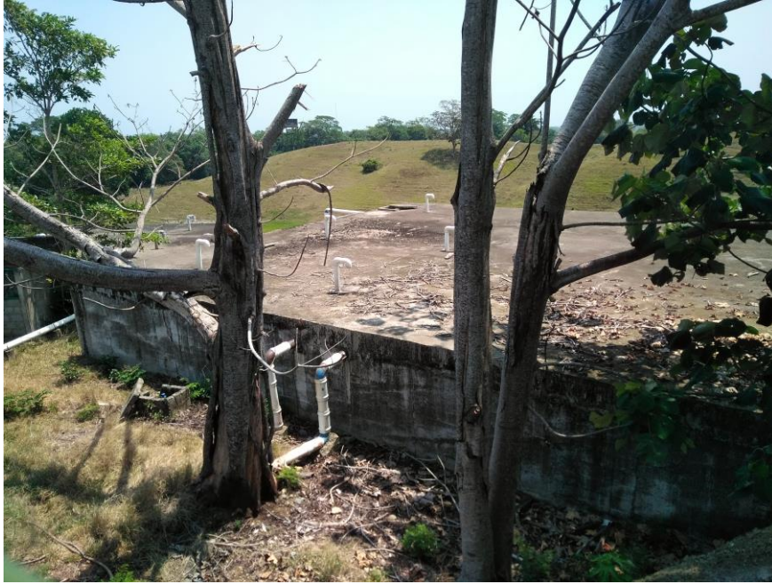
Imagen 29 Tanque de almacenamiento. Fuente: Visita SSPD, 2018.
