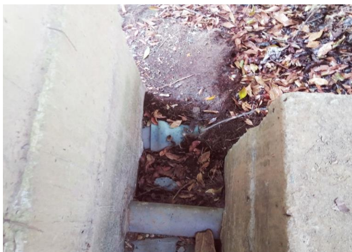
Imagen 21. Tubería de salida del desarenador. Fuente: Visita SSPD, 2018.
