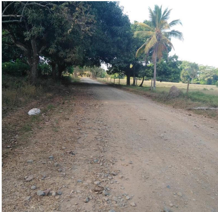
Imagen 56. Vía de acceso exterior al botadero a cielo abierto. Fuente: Visita SSPD 2018.
