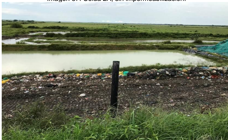
Imagen 37. Celda 2A, sin impermeabilización.
