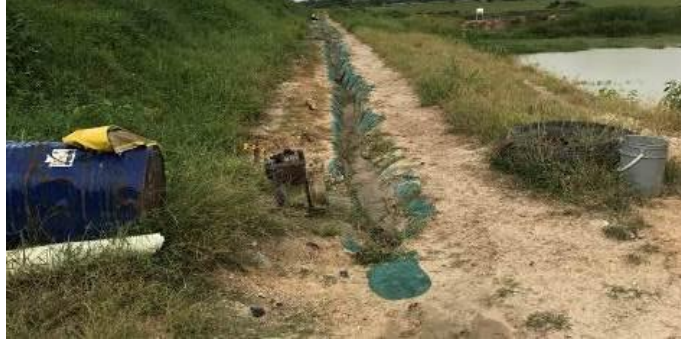
Imagen 42. Canaletas en mal estado.
