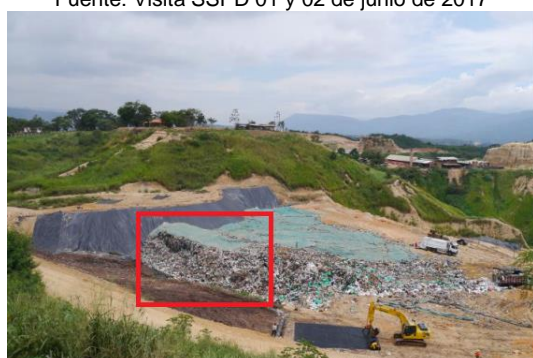
Residuos compactados sin cobertura Fuente: Visita SSPD 01 y 02 de junio de 2017
