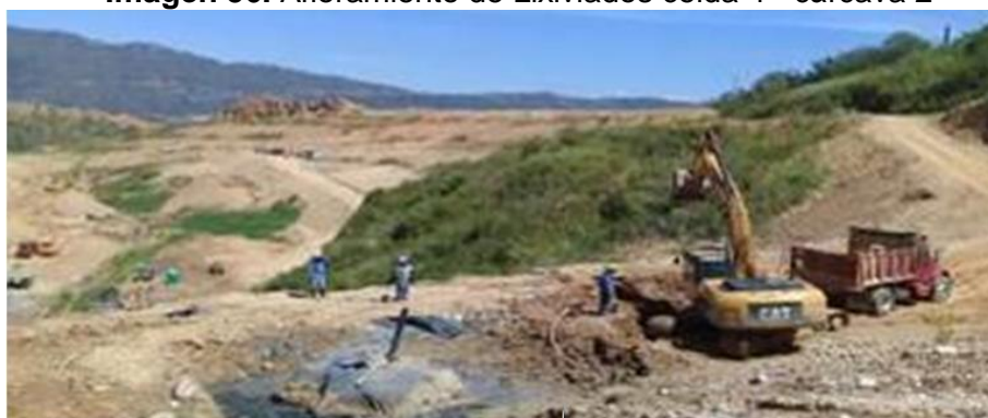
Imagen 56. Afloramiento de Lixiviados celda 4 - cárcava 2
