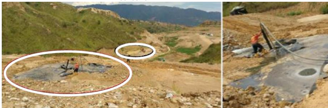
Imagen 57. Rebose y acumulación de lixiviados en el filtro principal de la celda 4 cárcava 2.
