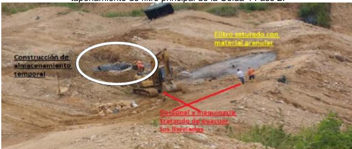
Imagen 58. Construcción almacenamiento temporal en la zona donde ocurrió taponamiento de filtro principal de la Celda 4 Fase 2.
