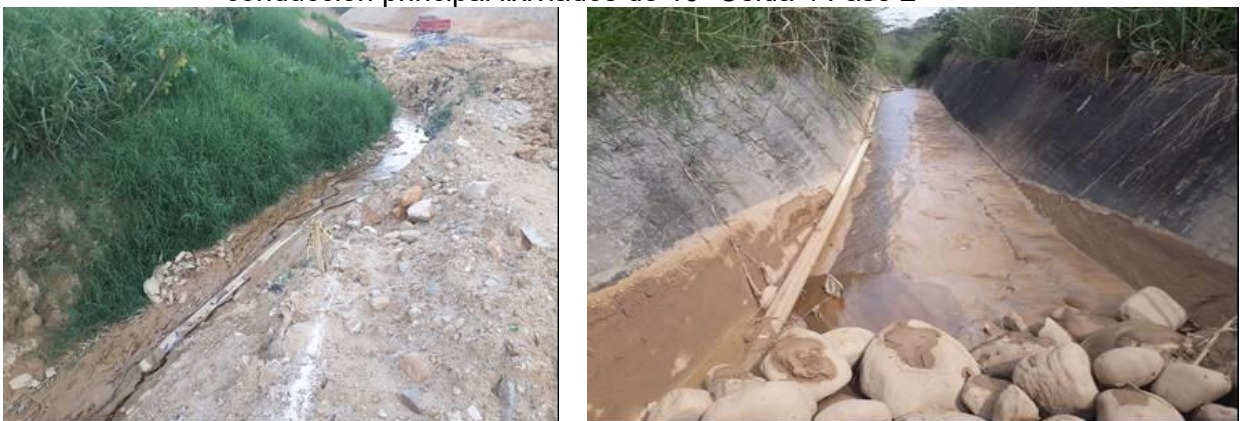
Imagen 6. Presencia de trazas de lixiviados en la Cañada El Carrasco, sobre conducción principal lixiviados de 10" Celda 4 Fase 2
