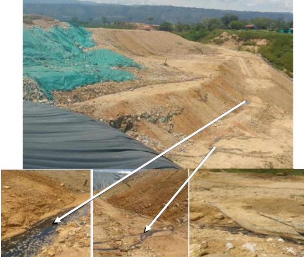
Imagen 61. Afloramiento de lixiviados en la parte alta de la celda 4 cárcava 2
