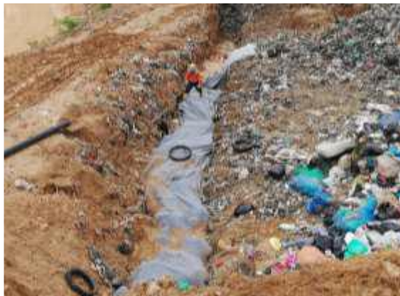
Filtro perimetral – Manejo lixiviados
