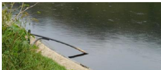
Tubería de descarga celda clausurada
