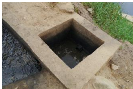
Caja de paso de flujo de lixiviados descargados por los vehículos recolectores
