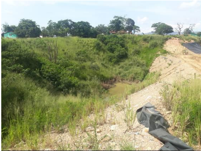
Acumulación de aguas lluvias costado Nororiental Celda 4 Fase 2, colindando con el predio El Fincal
