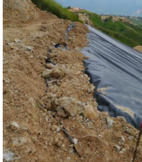
Ausencia de canales perimetrales en el vaso activo
