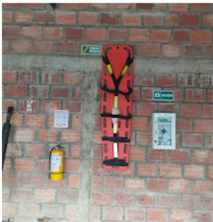
Imagen 3. Extintor, camilla, botiquín
