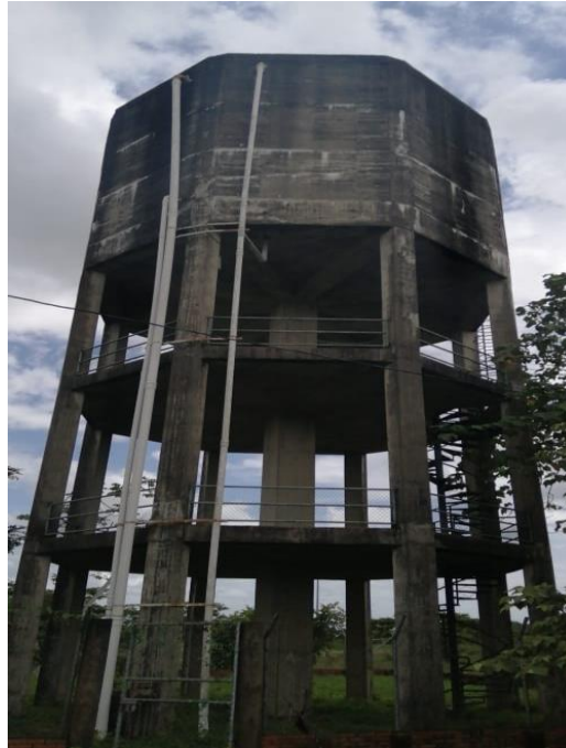
Tanque La Villa Fuente: Visita SSPD, junio de 2019
