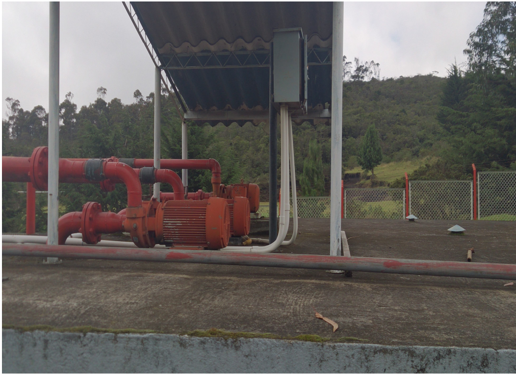
Figura 4. Ubicación de las bombas de agua.
