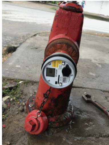
Hidrante Cra. 60 este con Cll. 31 mz 16 Barrio la Reliquia
