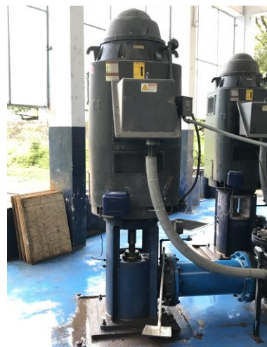
Bombas de 600 Hp
