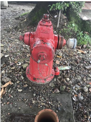
Hidrante Calle 44 Cra. 46 – 72
