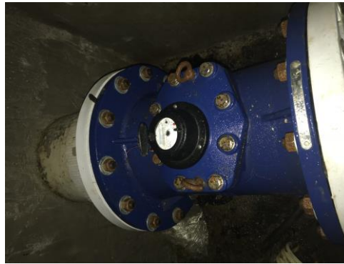
Macromedidor a la salida
