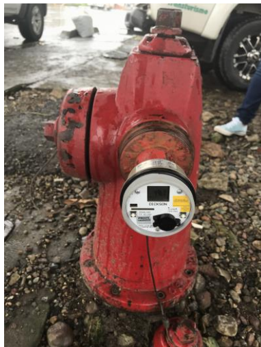
Hidrante Calle 44 Cra. 46 – 72
