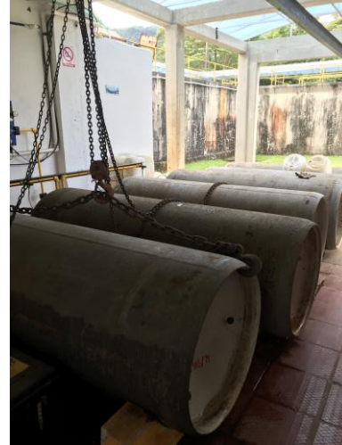
Cilindros de Cloro Gaseoso
