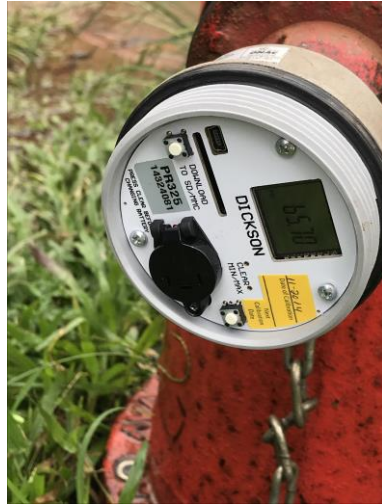
Hidrante Cra. 40 con Cll. 32, barrio Barzal
