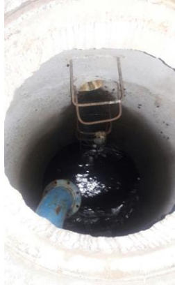
Pozo CII 22b sur # 36b – 16, mz 8, casa 4, barrio Guatapé 2.
