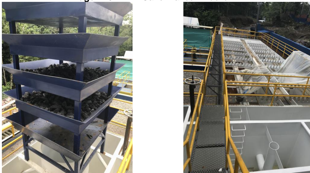
Fuente: Registro fotográfico de la visita SSPD 26/04/2018
