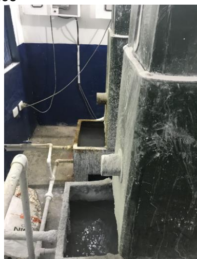
Dosificadores de Cal y Coagulante
