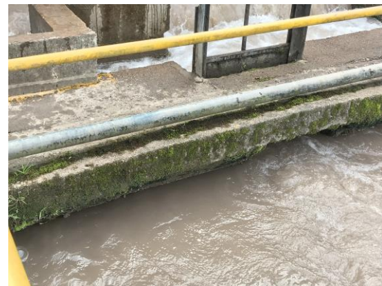
Algas en los muros de los floculadores
