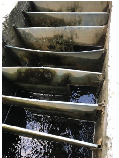
Celdas de los Floculadores
