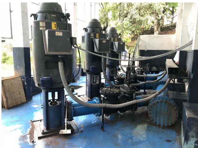
Bombas de 600 Hp
