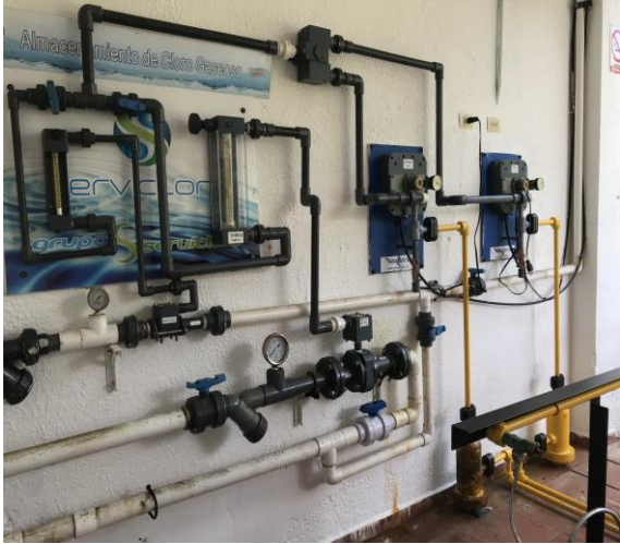
Cuarto de cloración
