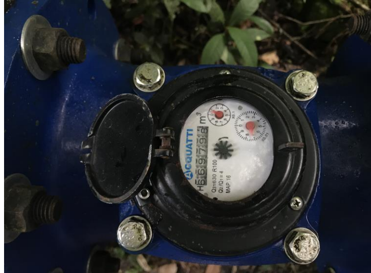
Macromedidor a la entrada
