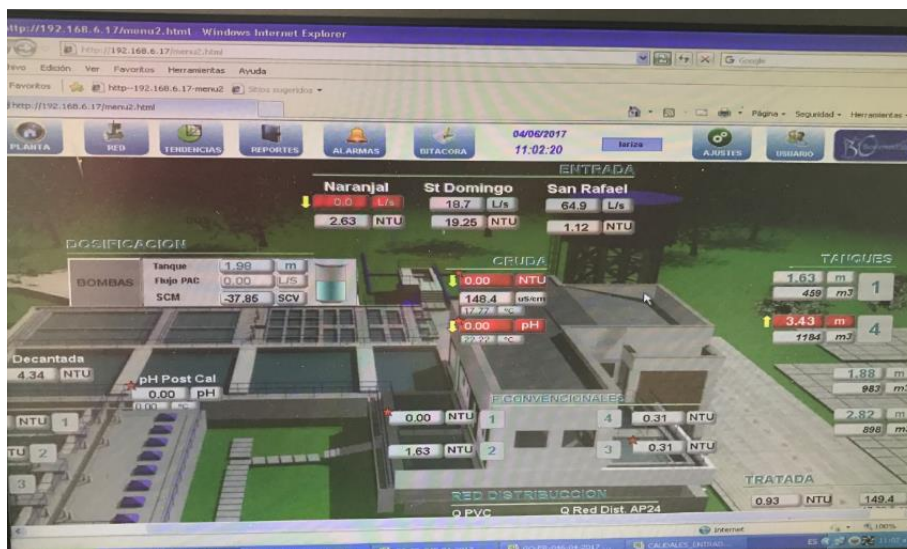
Figura 24. Sistema SCADA para la operación de la PTAP
