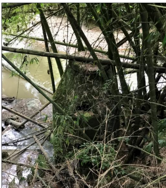
Figura 61. Pozo de Inspección Ubicado Sobre la Quebrada El Pescador – Proyecto Interceptor Pescador.
