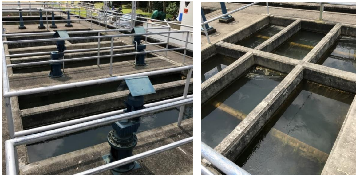
(a). Floculadores mecánicos
