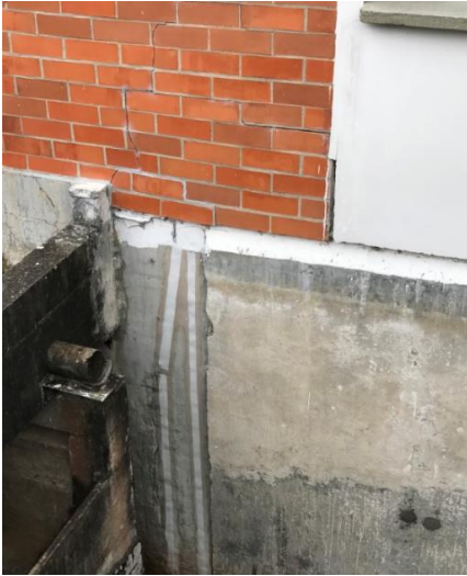
a) Grieta existente en el muro de tanque de la PTAP, adyacente a la casa de oficinas
