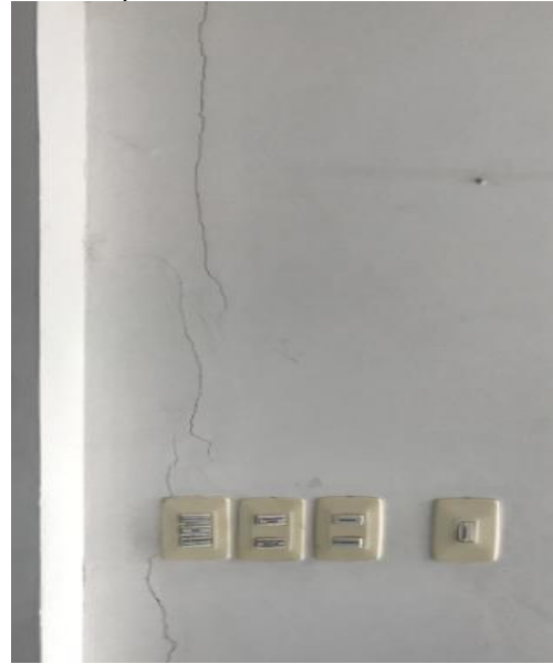
b) Grieta interna en la casa de oficinas de la PTAP
