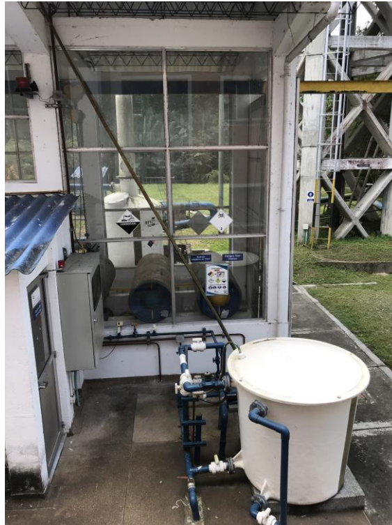
Figura 31. Zona de almacenamiento del Cloro Gaseoso en la PTAP del municipio de Calarcá, Quindío.
