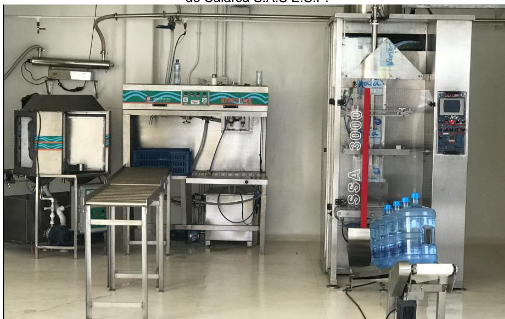
Figura 32. Planta embotelladora de agua envasada, propiedad de la Empresa Multipropósito de Calarcá S.A.S E.S.P.
