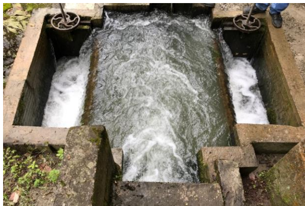
Figura 21. Cámara de Repartición de Caudales en Bocatoma de Río Santo Domingo
