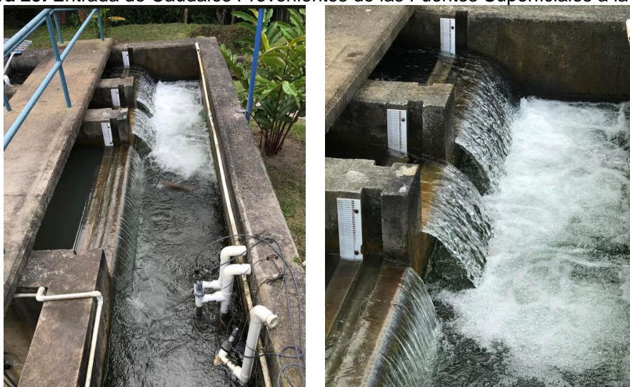
Figura 25. Entrada de Caudales Provenientes de las Fuentes Superficiales a la PTAP
