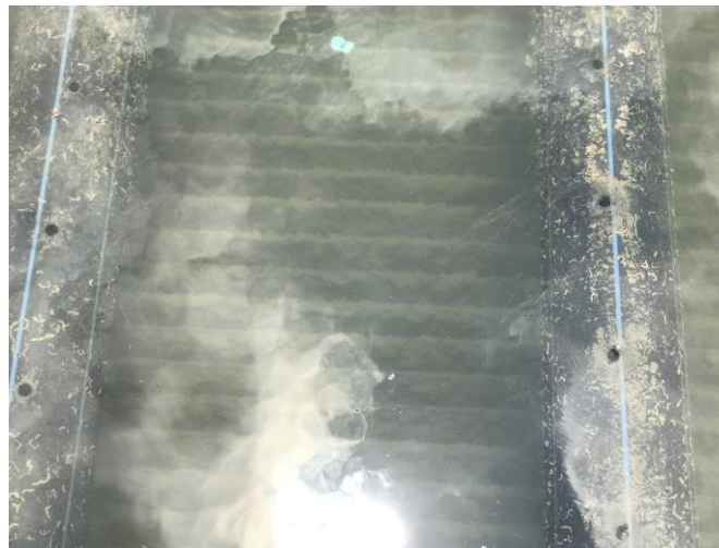
Figura 29. Vista de las placas y tuberías del sedimentador de la PTAP del municipio de Calarcá, Quindío.
