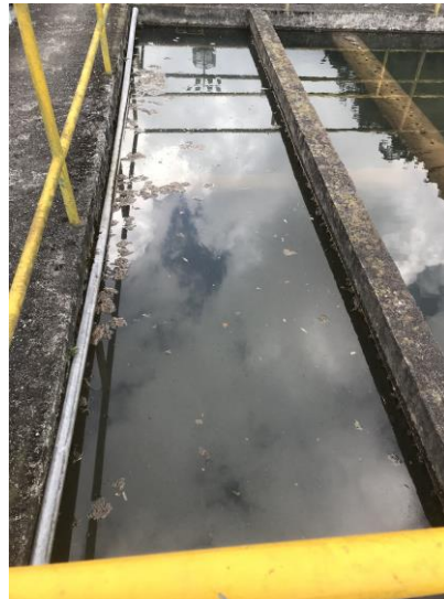
Imagen 23 Material suspendido en el canal de repartición de agua floculada
