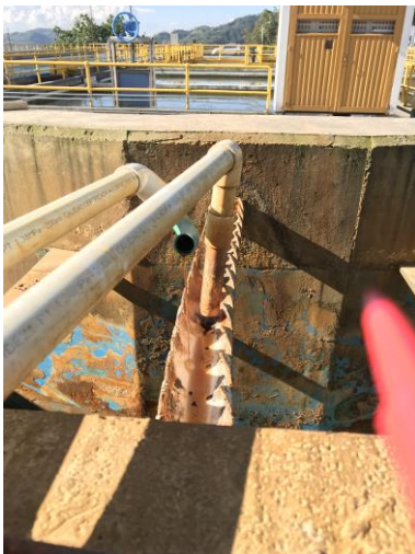
Punto de dosificación del coagulante
