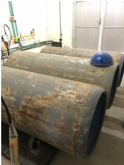
Tanques de cloro gaseoso
