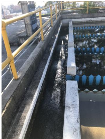
Canal de recolección de agua sedimentada
