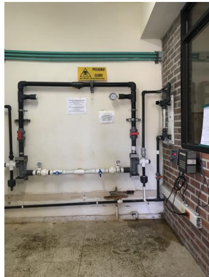
Cuarto de Cloración
