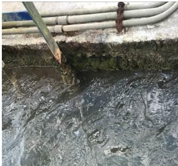
Imagen 25 Algas en los muros del canal de repartición del agua floculada
