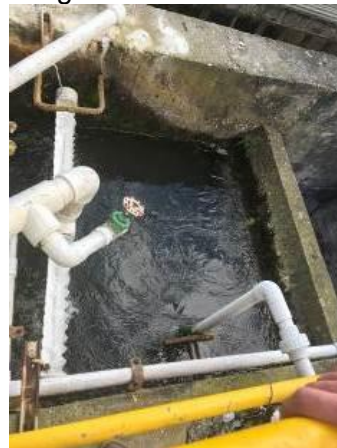
Imagen 21 Algas en los muros de la PTAP
