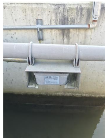
Sensor de nivel para medir el caudal de entrada
