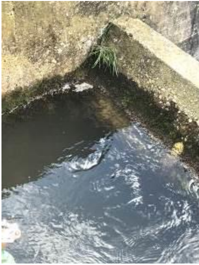
Imagen 22 Algas en los muros de la PTAP
