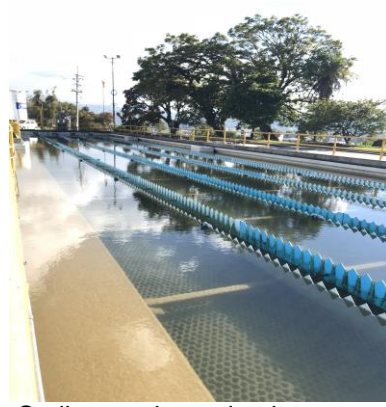
Sedimentadores de alta tasa
