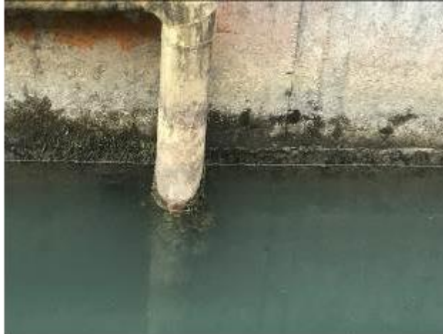
Imagen 26 Algas en muros de la PTAP
