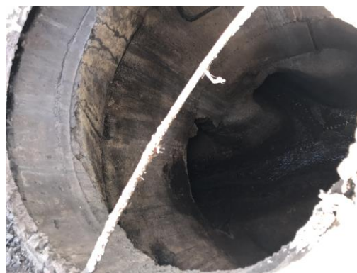
Imagen 39 Pozo de inspección Carrera 10 No 65 a - 39
