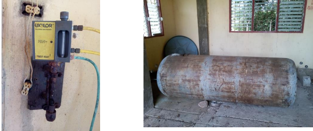
Figura 25 Cuarto de Cloración
