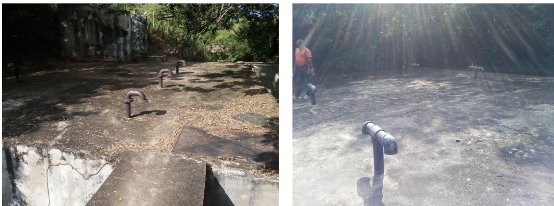
Figura 29 Tanques de Compensación en red de distribución
