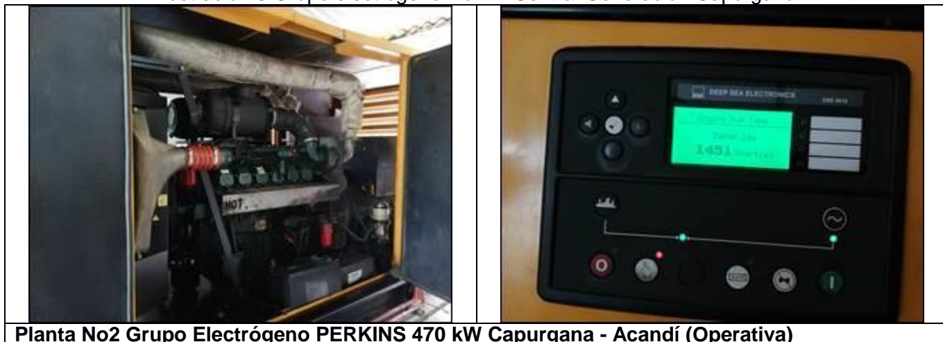
Ilustración 5 Grupo electrógeno No 2 – Central Generación Capurganá
