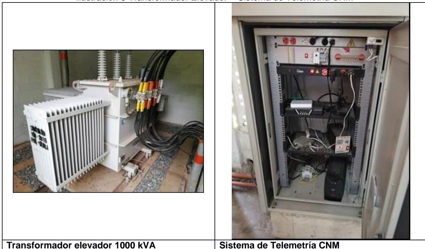
Ilustración 6 Transformador Elevador – Sistema de Telemetría CNM
