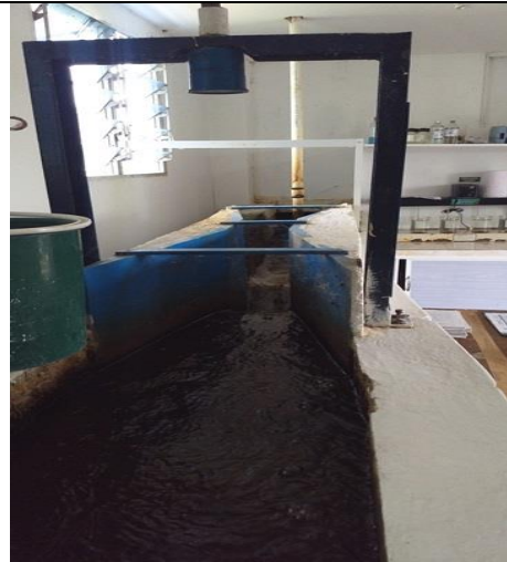
Imagen 26. Canaleta parshall PTAP municipal
