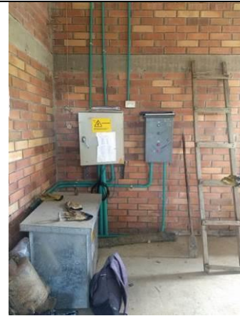
Imagen 59. Interior caseta de suministro de energía en punto de rebombeo
