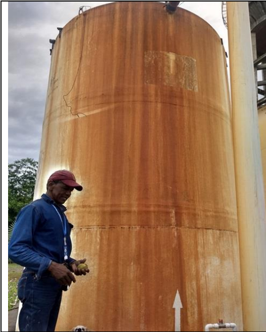
Imagen 21. Tanque de oxidación PTAP veredal
