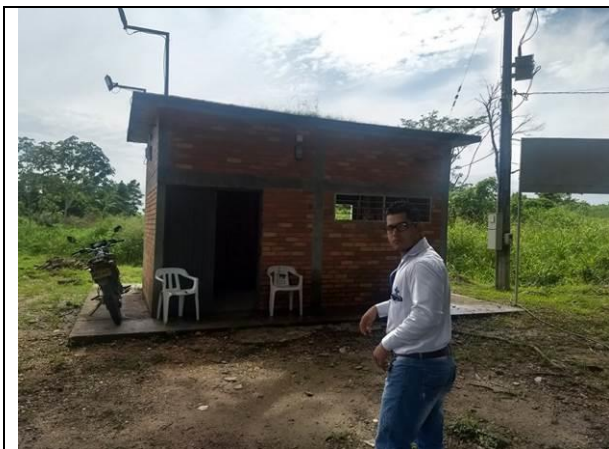
Imagen 58. Caseta de suministro de energía en punto de rebombeo
