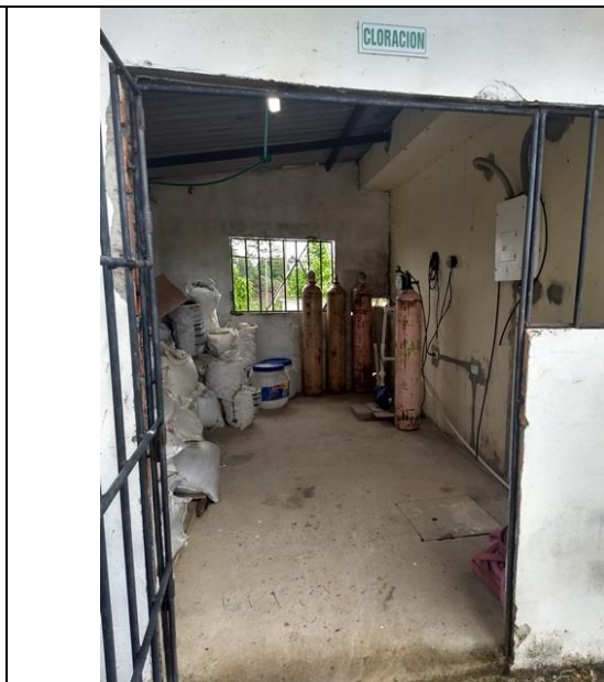
Imagen 37. Bodega almacenamiento productos químicos PTAP veredal
