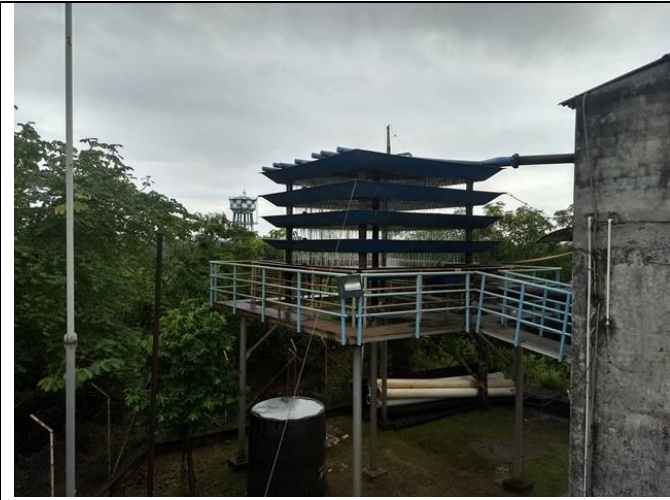
Imagen 25. Torre de aireación PTAP municipal
