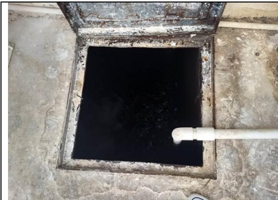
Imagen 40. Tanque de almacenamiento PTAP veredal
