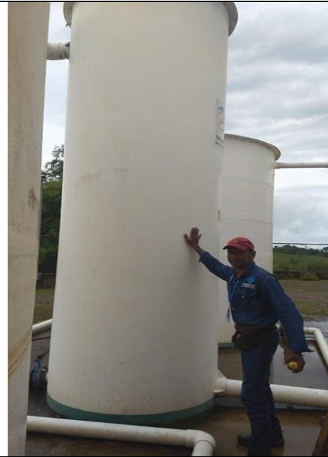
Imagen 22. Tanque de aquietamiento PTAP veredal
