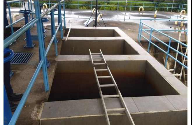
Imagen 28. Módulos de filtración PTAP municipal
