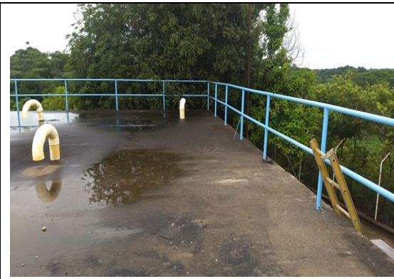
Imagen 41. Tanque de almacenamiento PTAP municipal
