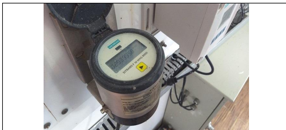
Imagen 47. Macromedidor PTAP municipal. Existe un macromedidor externo que envía señal a este equipo, ubicado dentro de la PTAP y registra la cantidad de agua que sale de la PTAP
