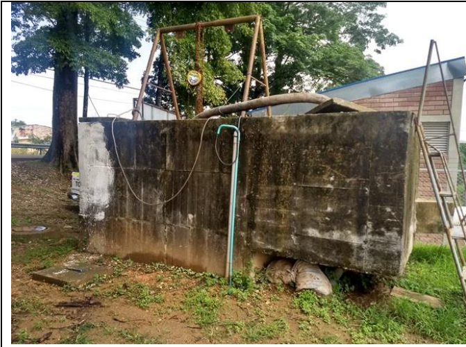
Imagen 60. Estación de rebomdeo en zona urbana
