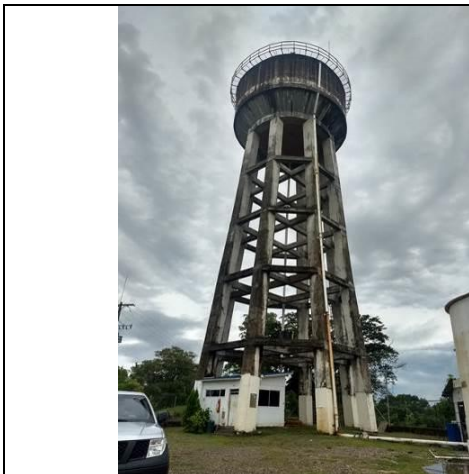
Imagen 42. Tanque de distribución PTAP veredal
