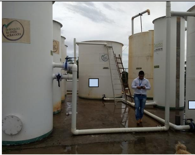
Imagen 23. Dos Módulos de sedimentación PTAP veredal
