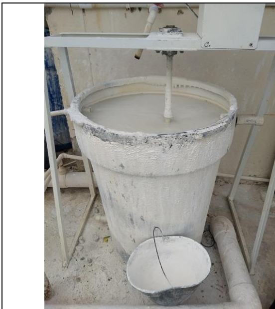
Imagen 36. Punto adición de cal PTAP veredal
