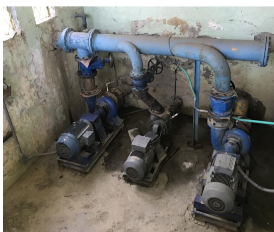
Bombas de tipo horizontal
