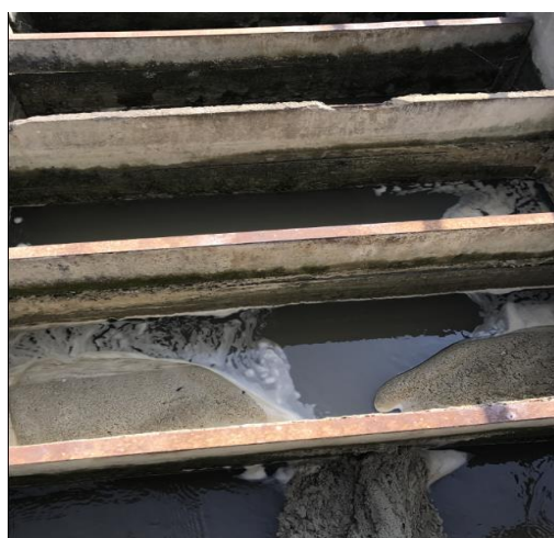
Placas del floculador
