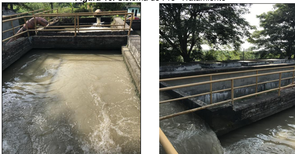
Figura 10. Sistema de Pre -Tratamiento
