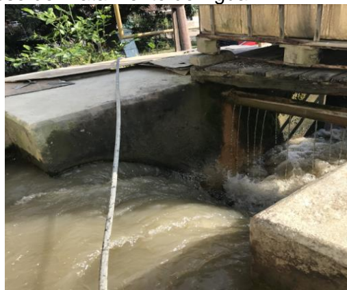
Mezcla rápida por resalto hidráulico
