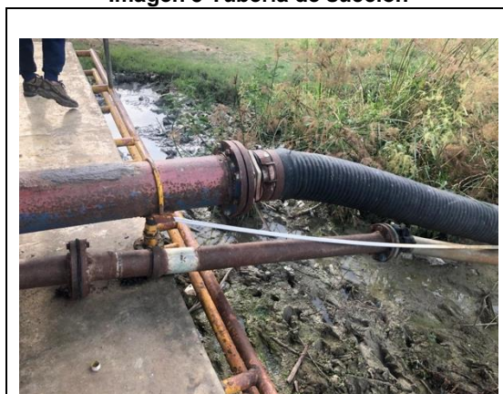
Imagen 5 Tubería de succión
