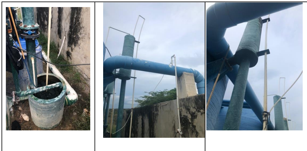
Imagen 15,16 y 17 Proceso de cloración
