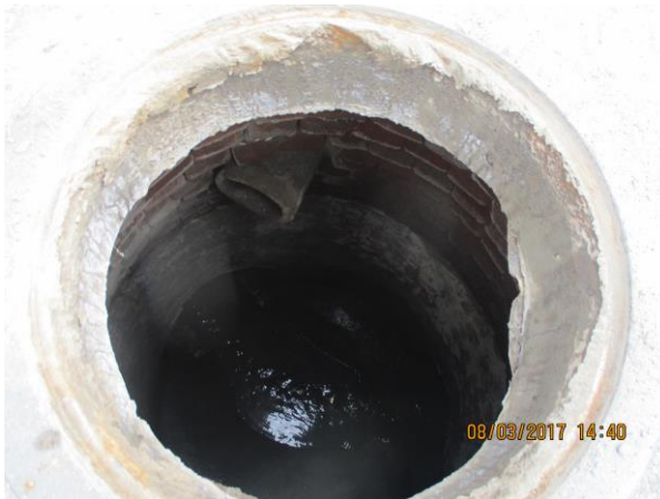
Figura 25 Pozo de inspección (carrera 3 con carrera 4 esquina)
