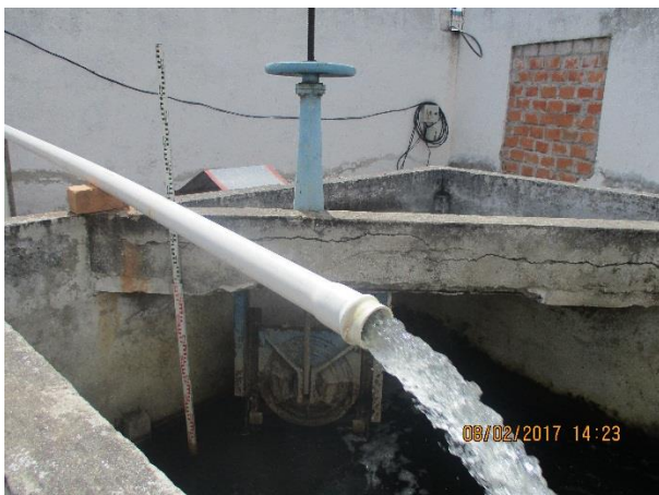
Figura 15 Tanque de entrada a la PTAP
