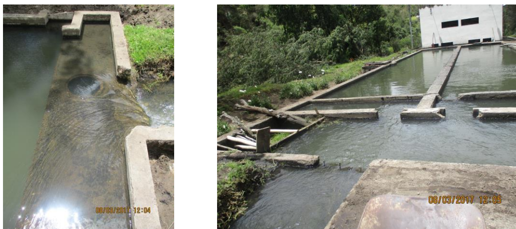
Figura 14 Deterioro del concreto de los desarenadores
