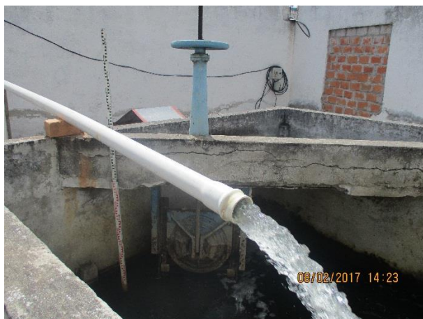
Figura 15 Tanque de entrada a la PTAP
