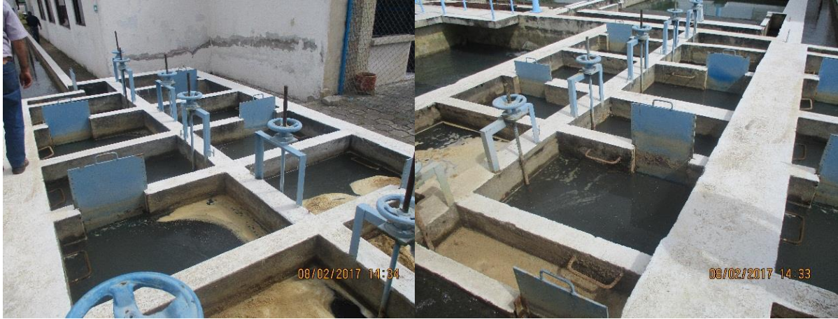
Figura 18 Floculadores Tipo Alabama "Planta 1"
