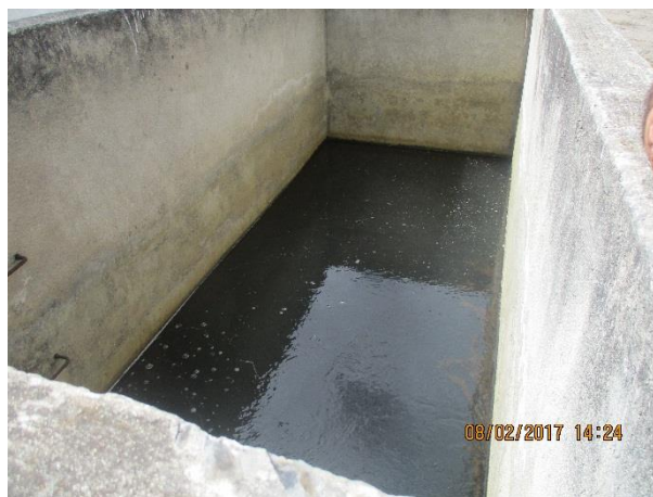
Figura 16 Tanque de aquietamiento
