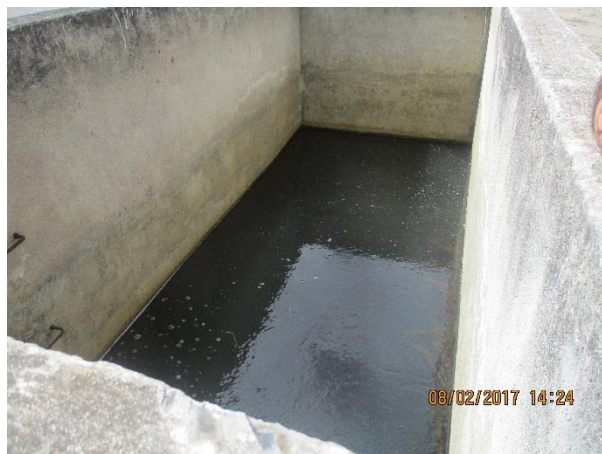
Figura 16 Tanque de aquietamiento
