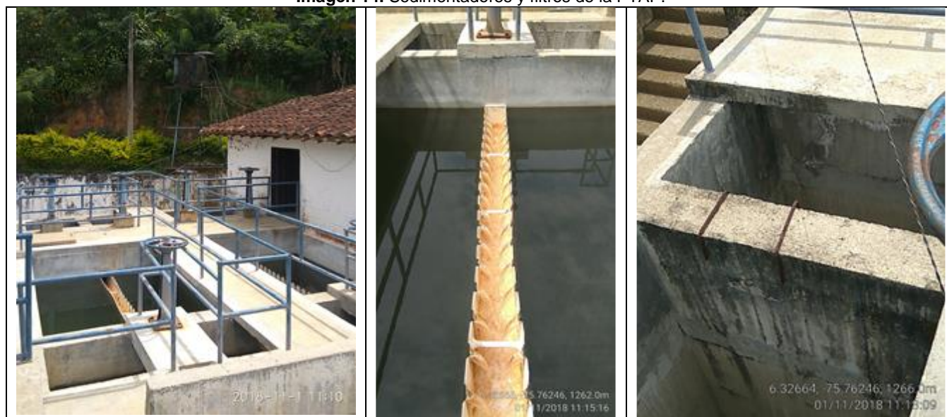
Imagen 14. Sedimentadores y filtros de la PTAP.
