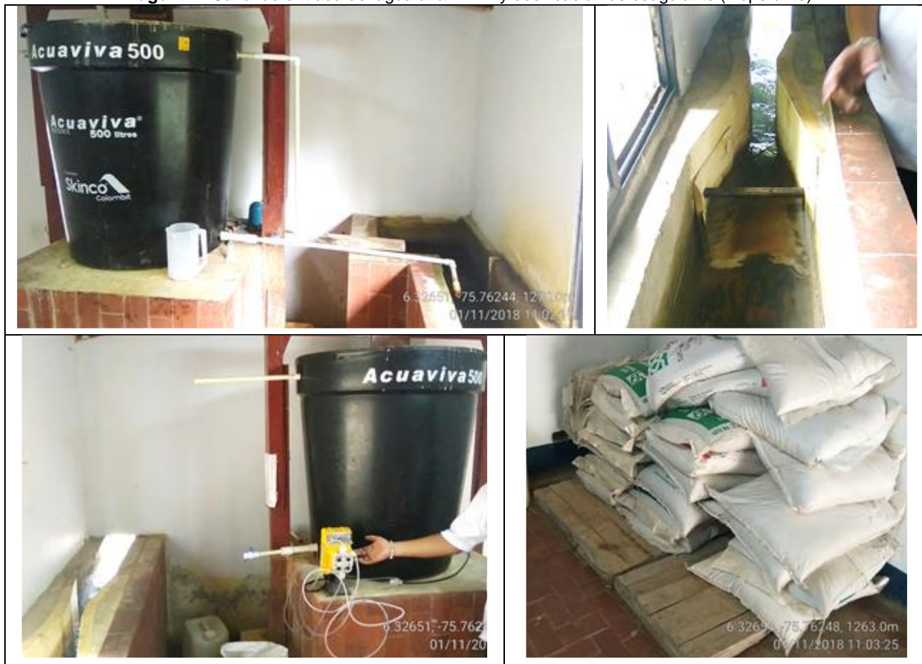
Imagen 12. Canal de entrada del agua a la PTAP y dosificación de coagulante (inoperante).
