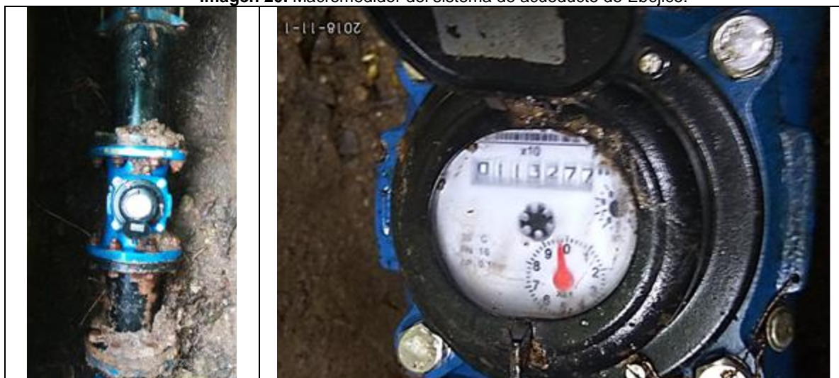
Imagen 20. Macromedidor del sistema de acueducto de Ebéjico.
