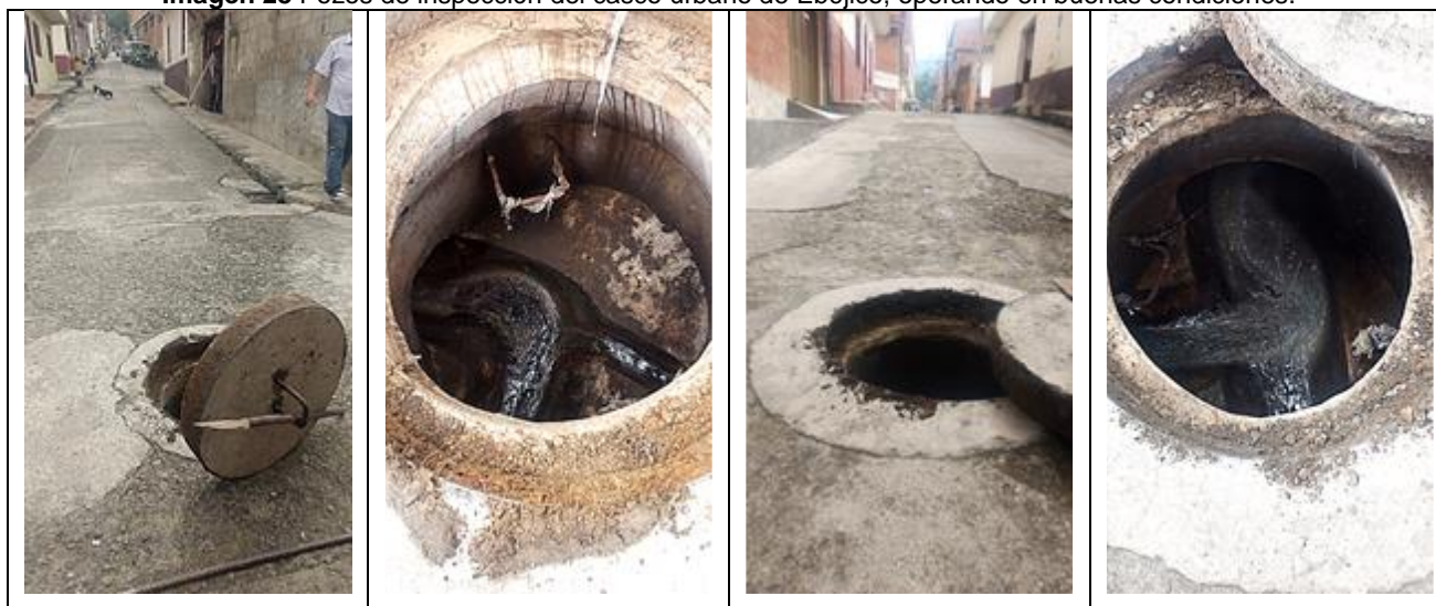
Imagen 28 Pozos de inspección del casco urbano de Ebéjico, operando en buenas condiciones.
