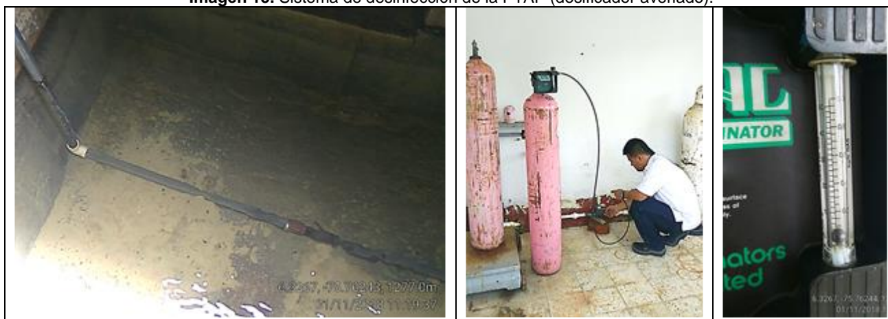
Imagen 15. Sistema de desinfección de la PTAP (dosificador averiado).
