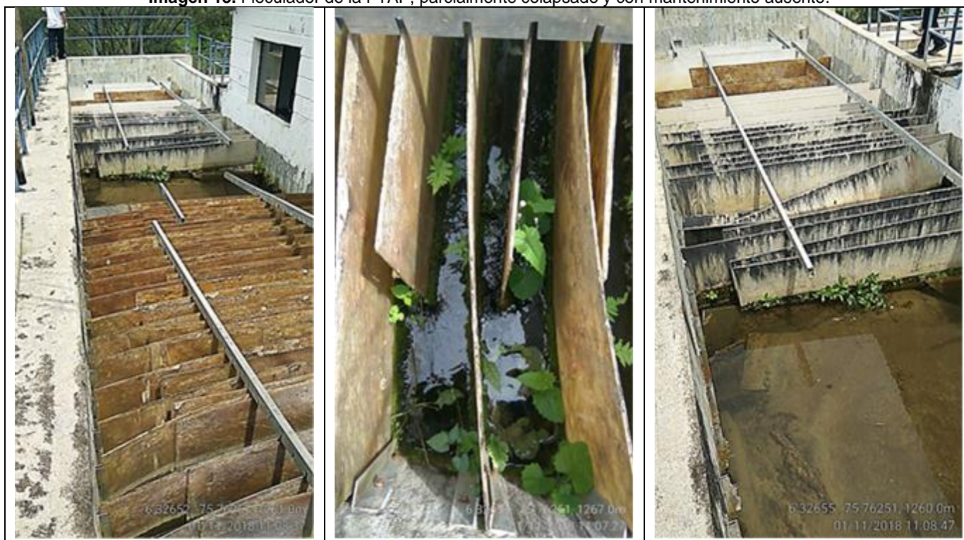
Imagen 13. Floculador de la PTAP, parcialmente colapsado y con mantenimiento ausente.
