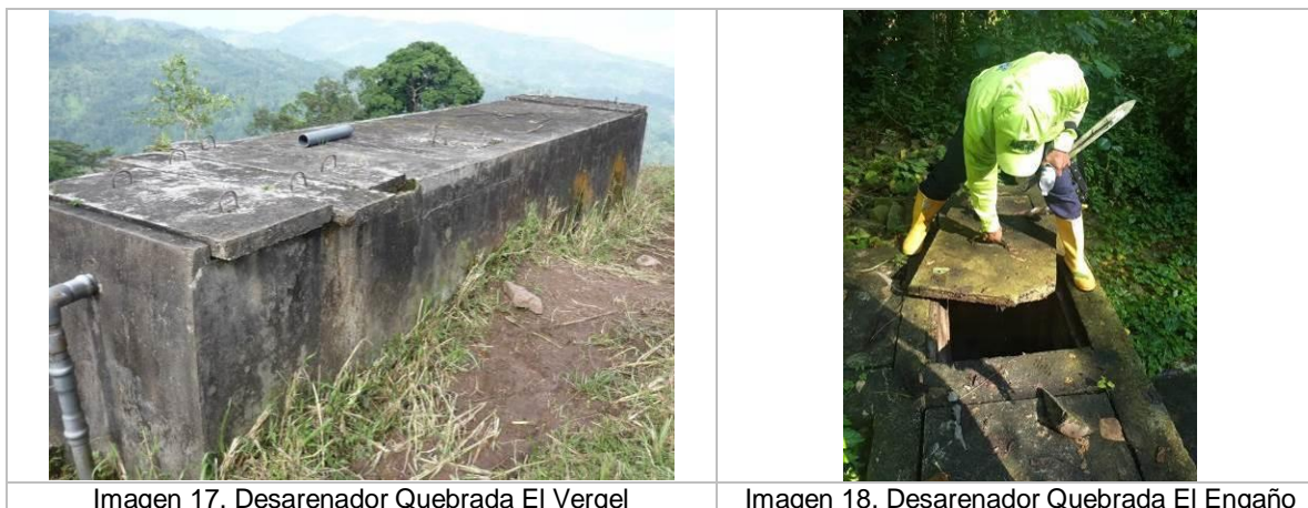
Imagen 17. Desarenador Quebrada El Vergel
