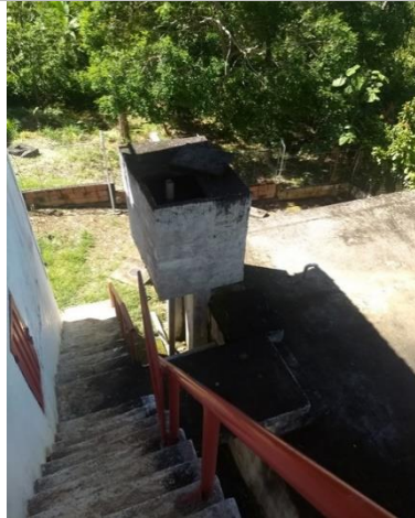
Imagen 33. Tanque de almacenamiento en primer nivel
