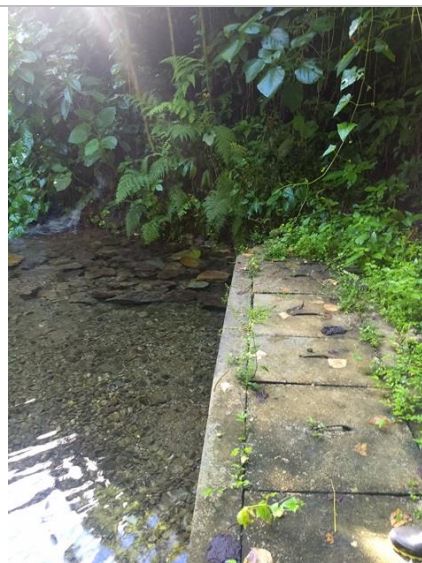
Imagen 13. Bocatoma quebrada El Engaño vereda El Cuarenta
