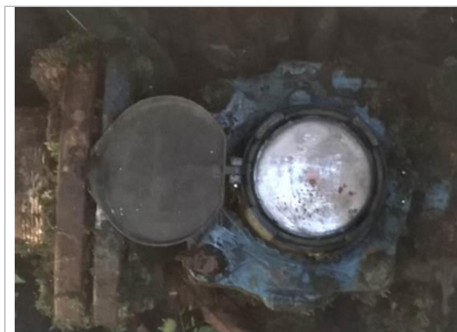
Imagen 37. Macromedidor a la salida del tanque de almacenamiento
