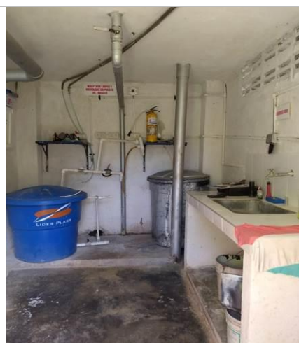
Imagen 28. Sistema de dosificación de productos químicos inoperativo
