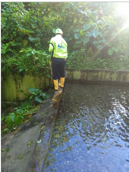
Imagen 12. Bocatoma quebrada El Engaño vereda El Cuarenta
