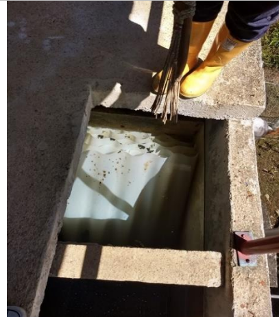
Imagen 24. Módulos de floculación
