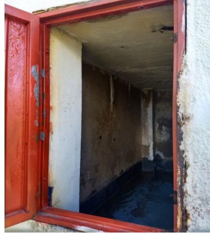
Imagen 26. Tanque de desinfección
