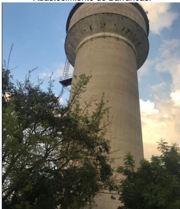
Figura 17. Tanque de almacenamiento presuntamente fuera de uso – Sistema de Abastecimiento de Barrancas.
