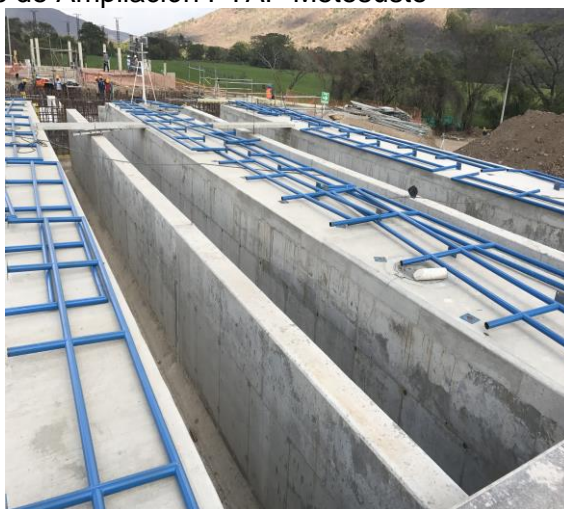
Sedimentadores en obra
