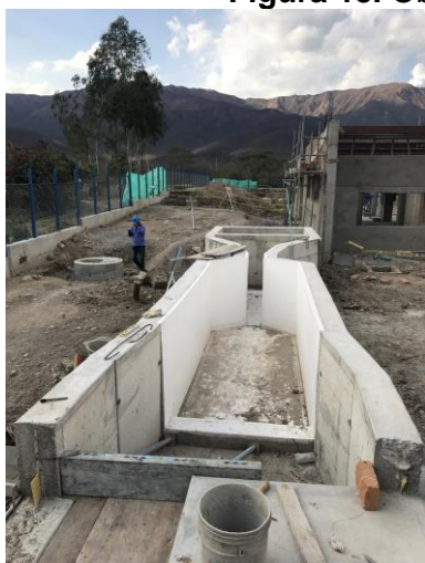
Canaleta Parshall en obra
