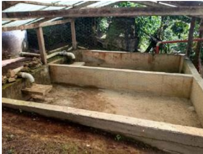
Imagen 6. Lechos de secado de lodos.
