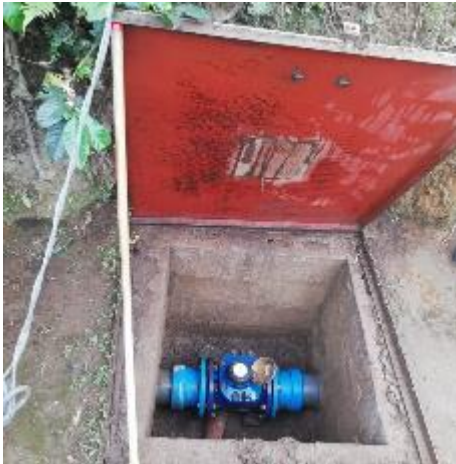
Macromedidor de salida
