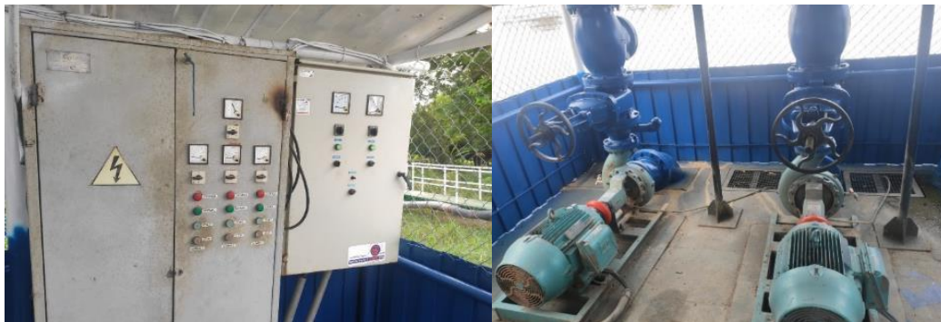
Imagen 7. Tablero de control y Bombas de succión - Barcaza
