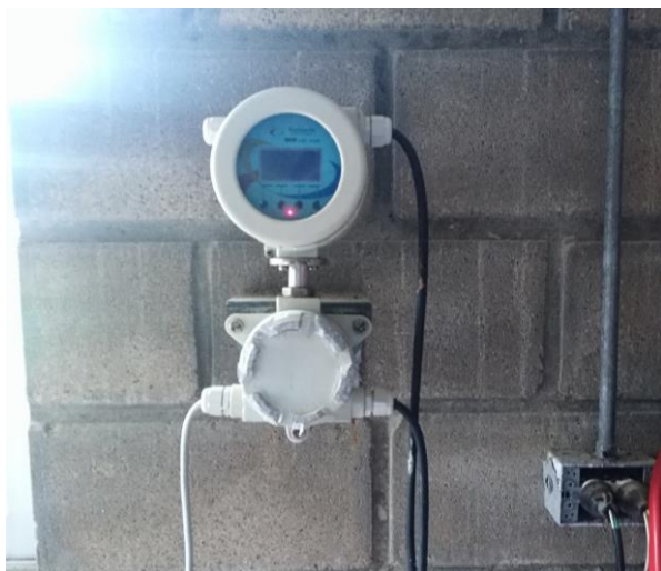
Imagen 41. Macromedidor ingreso PTAP zona urbana
