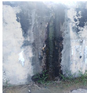
Imagen 35. Fugas tanque de almacenamiento
