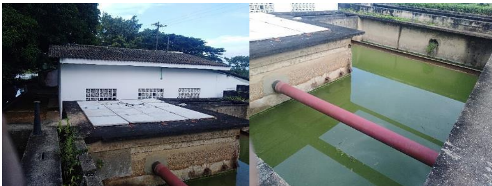
Imagen 9. Sistema de tratamiento antiguo inoperativo
