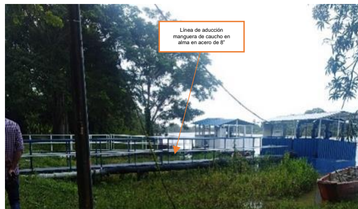
Imagen 8. Línea de aducción
