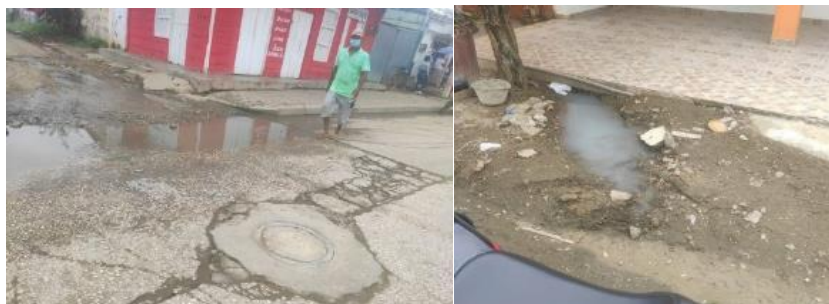
Imagen 55. Descarga de aguas residuales desde las viviendas
