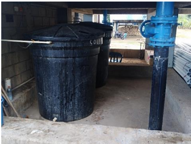
Imagen 14. Tanques de almacenamiento y preparación de coagulante
