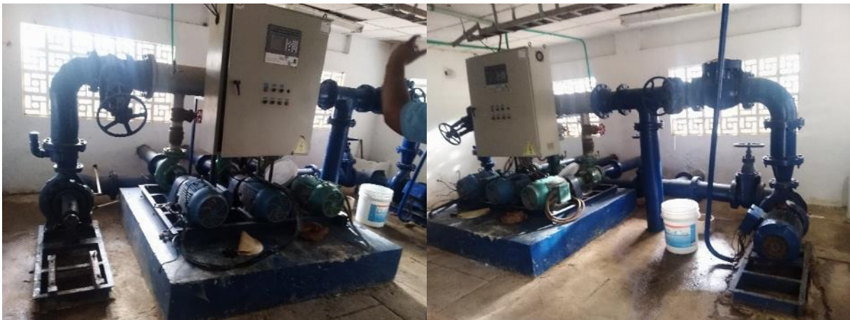
Imagen 38. Estación de bombeo a red de distribución – Zona urbana y parte de la zona rural Las Cañas, Calle Ralita, Pajonal
