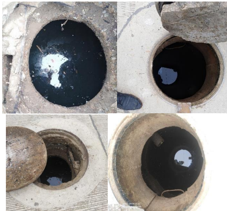
Imagen 49. Pozos de inspección
