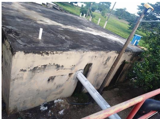
Imagen 34. Tanque de almacenamiento PTAP – Zona Urbana
