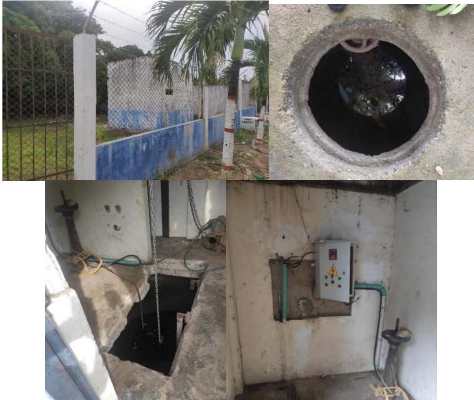
Imagen 51. Estación de bombeo de aguas residuales
