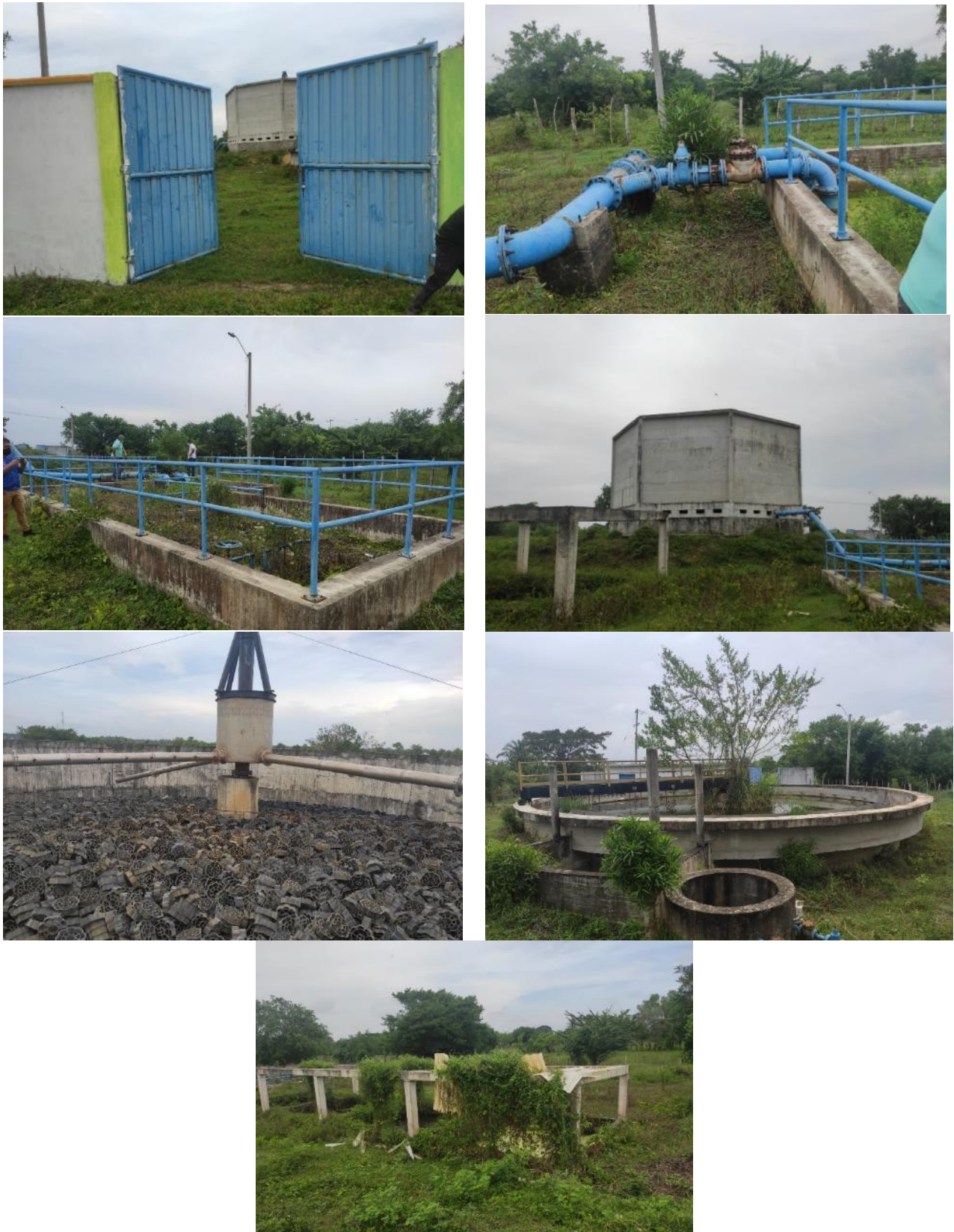
Imagen 52. Sistema de tratamiento de aguas residuales inoperativo
