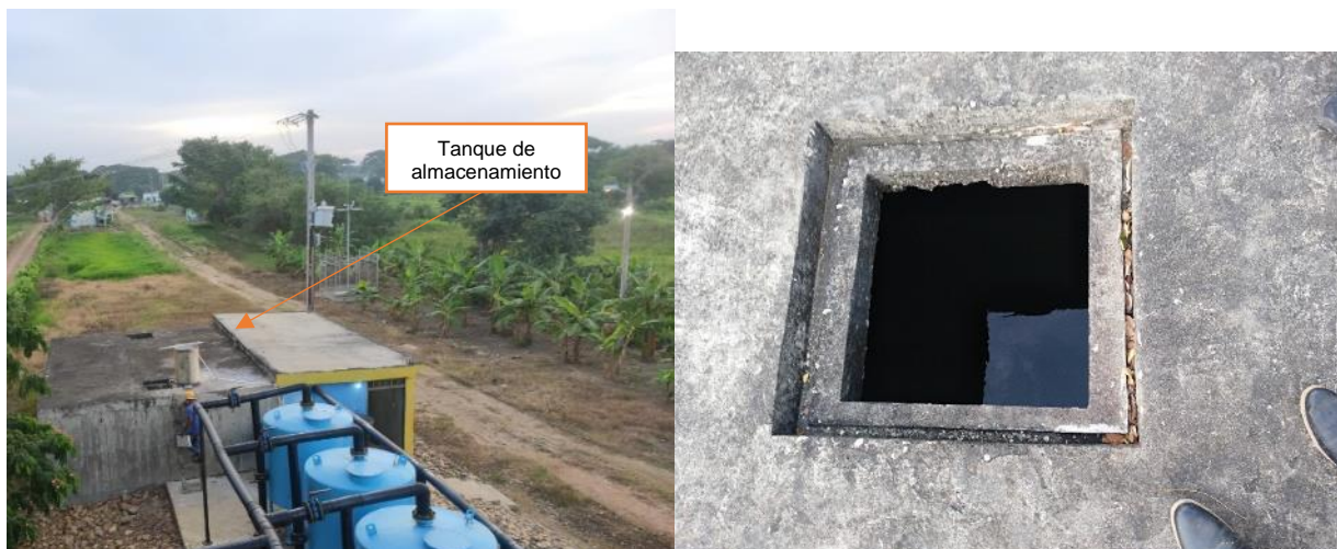
Imagen 36. Tanque de almacenamiento PTAP – Zona Rural
