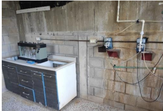
Imagen 28. Área de laboratorio – Equipo de prueba de jarras
