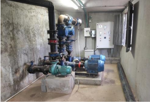
Imagen 39. Estación de bombeo a red de distribución – Zona rural
