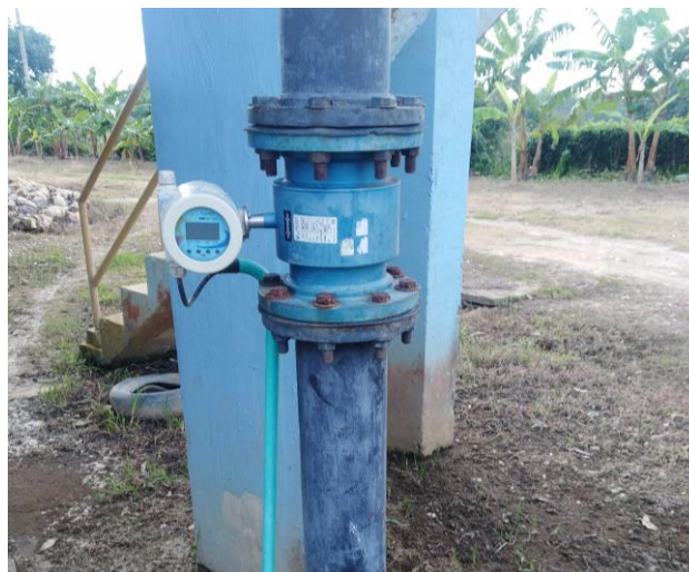
Imagen 42. Macromedidor ingreso PTAP zona Rural
