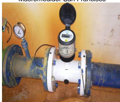
Macromedidor Caminos Vecinales
