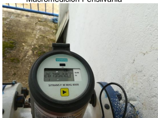
Macromedidor San Francisco
