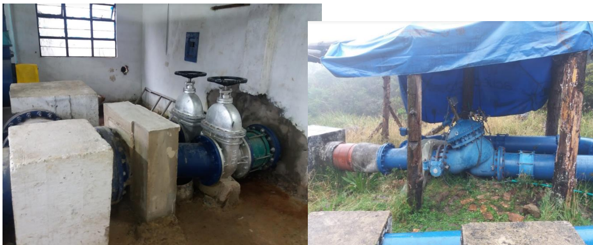
Sistema de regulación. Válvula reguladora y macromedición Fuente: Registro fotográfico SSPD – visita abril de 2018
