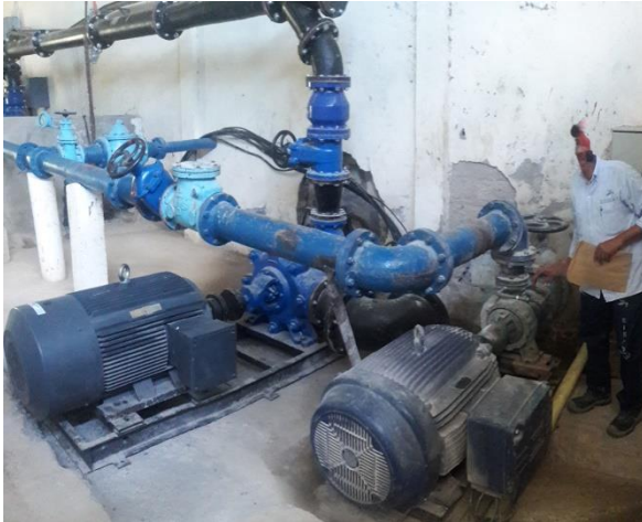
Bomba en operación.
