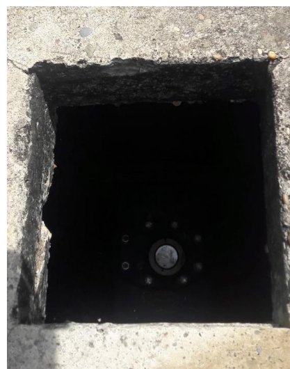
Macromedidor salida Tanque Elevado
