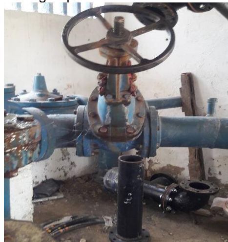
Fugas en el sistema de bombeo
