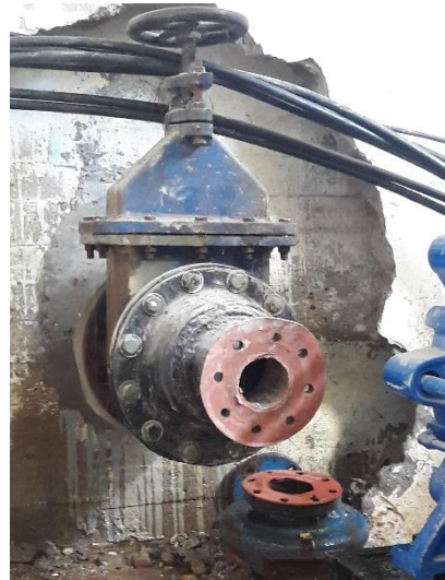
Fugas en el sistema de bombeo.
