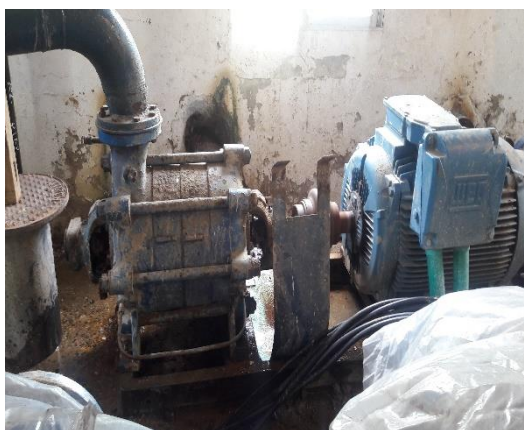
Bomba en operación
