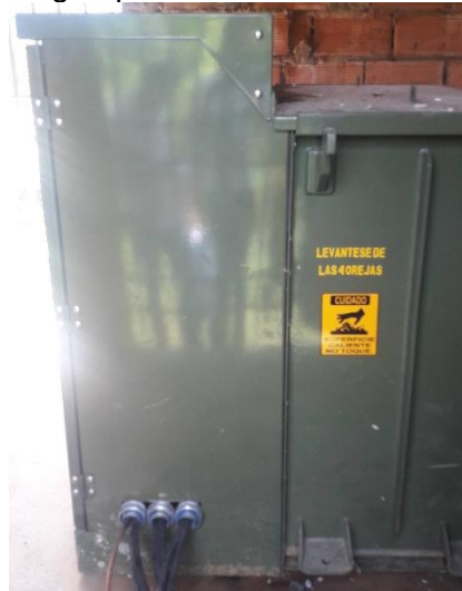
Planta generadora Nueva.
