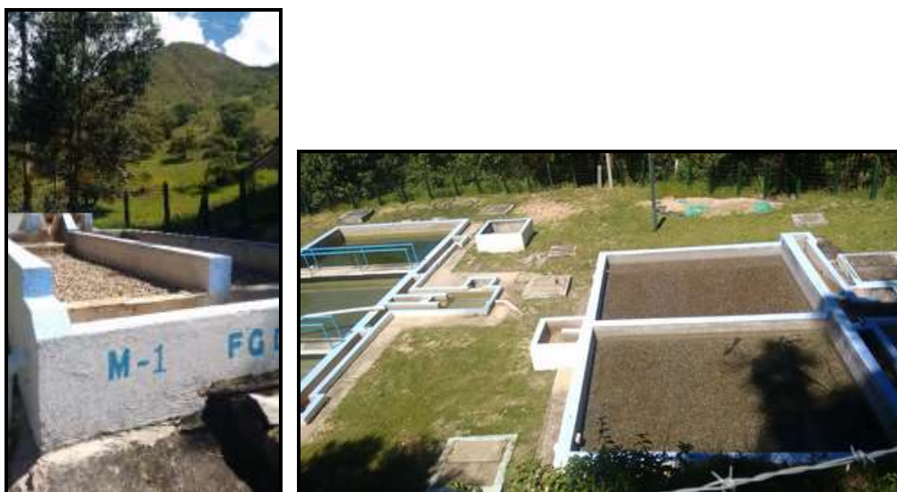
Imagen 29 Planta de Tratamiento Urbana
