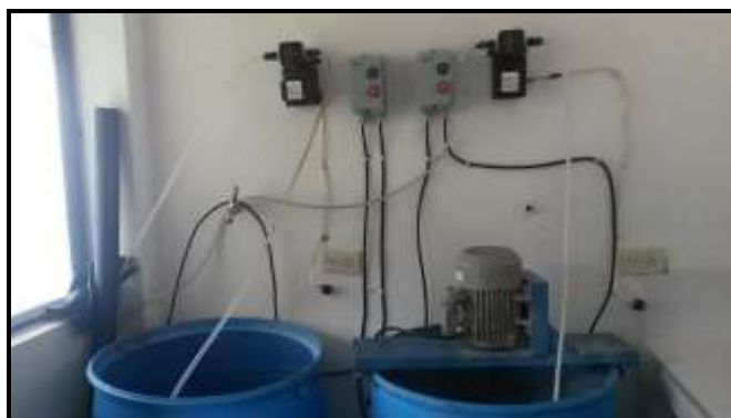
Imagen 32 Dosificación y químicos utilizados en el tratamiento Las Mercedes
