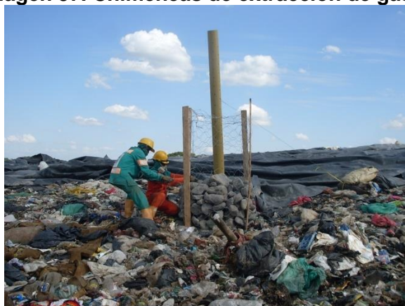
Imagen 57. Chimeneas de extracción de gases
