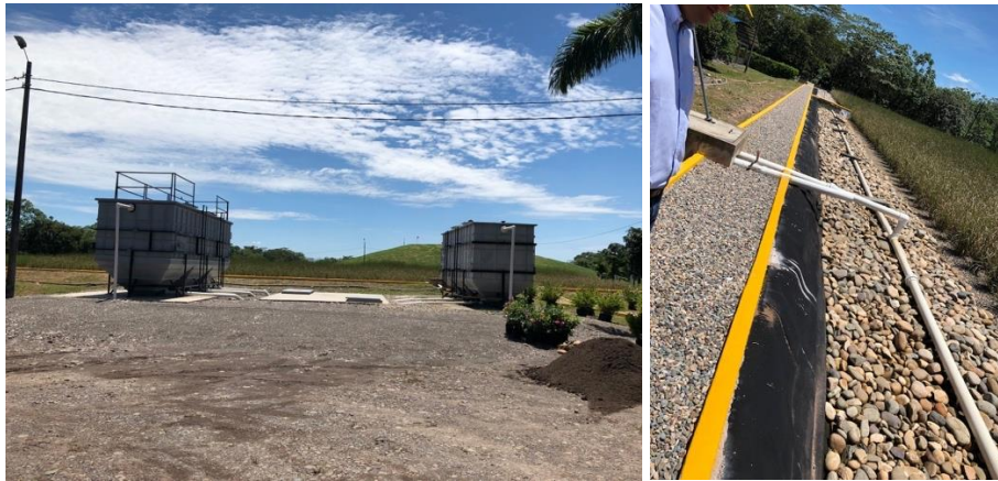
Imagen 55. Sistema de afino de la planta de tratamiento de lixiviados
