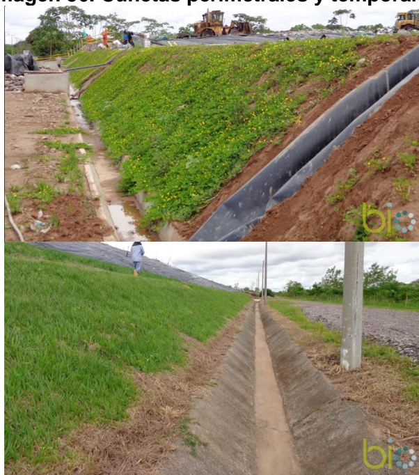
Imagen 56. Cunetas perimetrales y temporales
