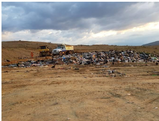
Ilustración 94. Frente de trabajo. Fuente: Visita de inspección y vigilancia del 20 y 21 de noviembre de 2017
