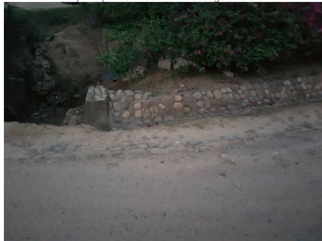
Ilustración 108. Cuneta perfilada en material pétreo trazada sobre la vía principal con conexión a desagüe natural.
