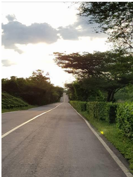
Ilustración 82. Vía principal pavimento con señalización horizontal.
