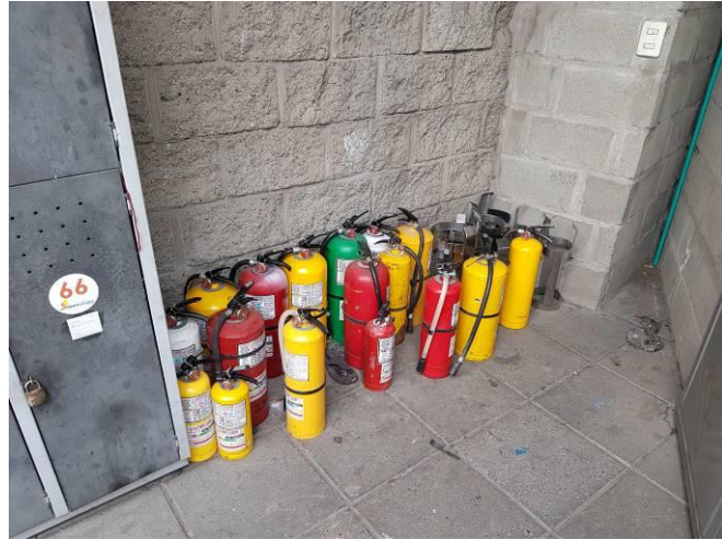
Ilustración 57. Stock de extintores.
