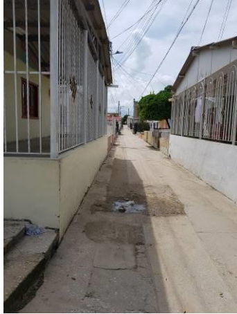
Ilustración 7. Tramos viales de calzadas reducidas. Fuente: Visita de inspección y vigilancia del 21 y 22 de septiembre de 2017
