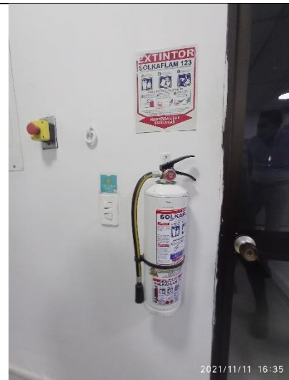
Extintores en base de operaciones
