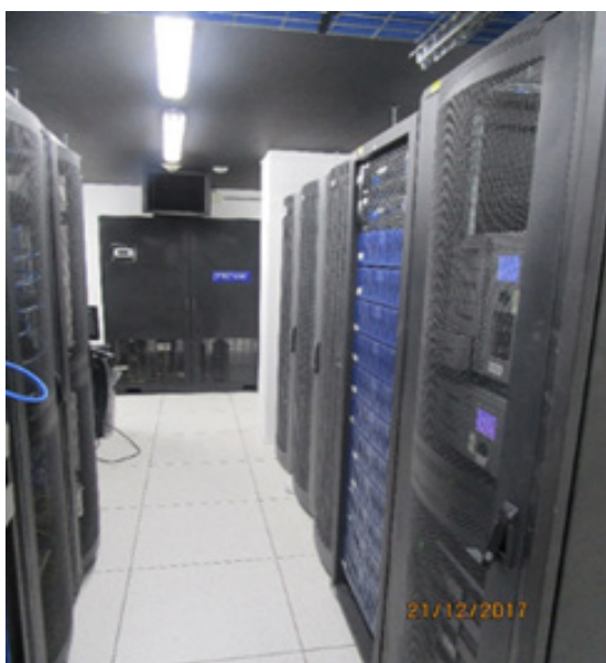
Rack de servidores de data center
