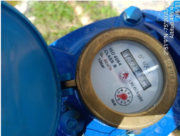
Macromedidor pozo profundo PTAP Llanos de Vimianzo Club.
