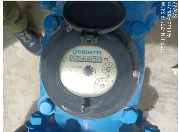
Macromedidor pozo profundo PTAP Coruña.
