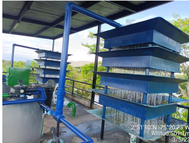
Fuente: visita de inspección del 2 al 4 de mayo de 2023 a SEMDO S.A.S. E.S.P.
