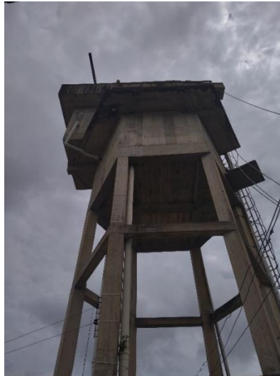
Imagen 9. Tanque de almacenamiento
