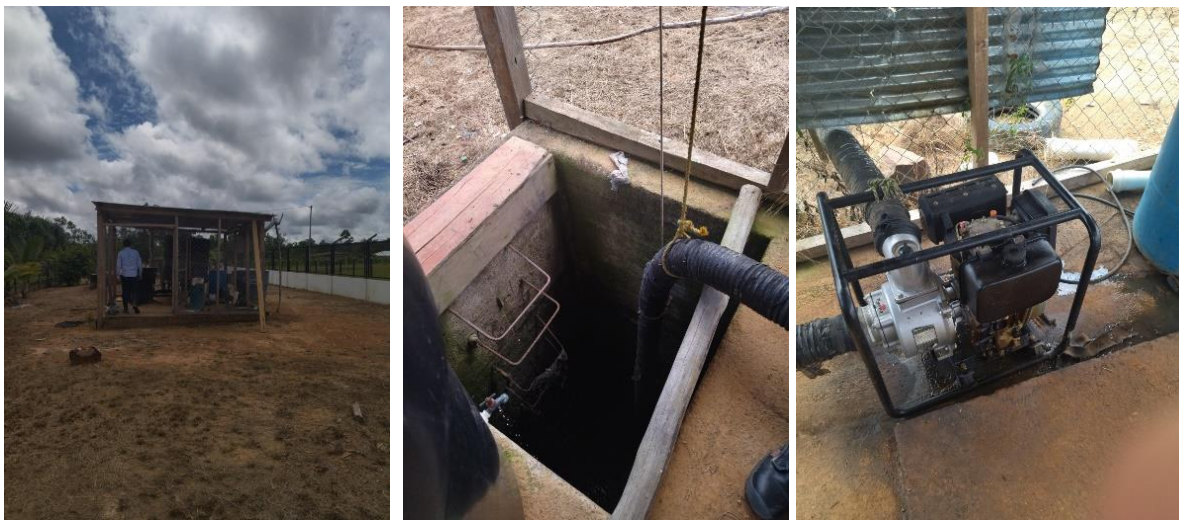
Imagen 13. Estación de bombeo
