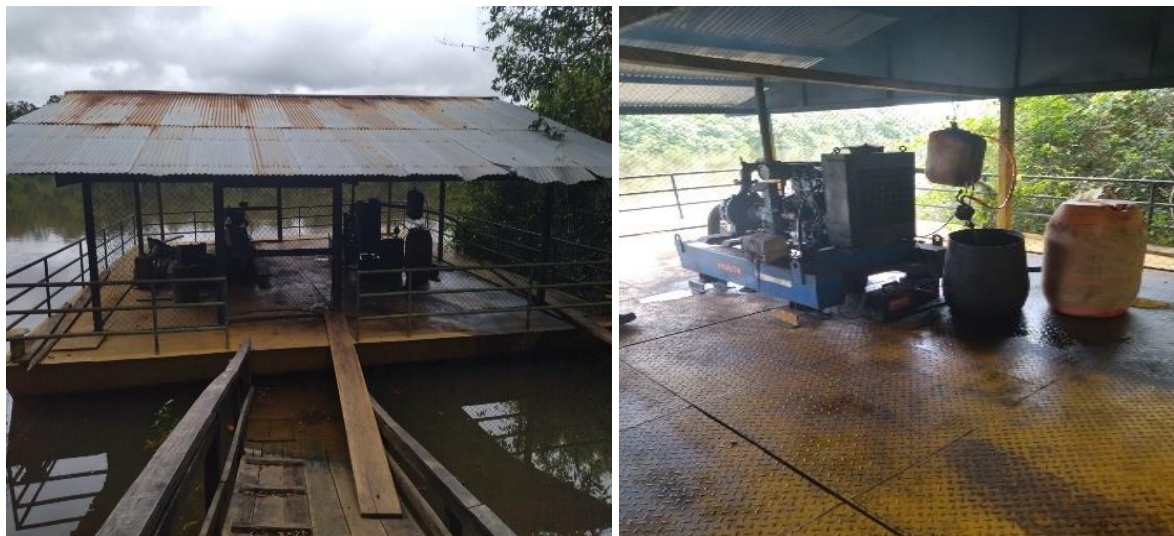
Imagen 5. Captación barcaza flotante
