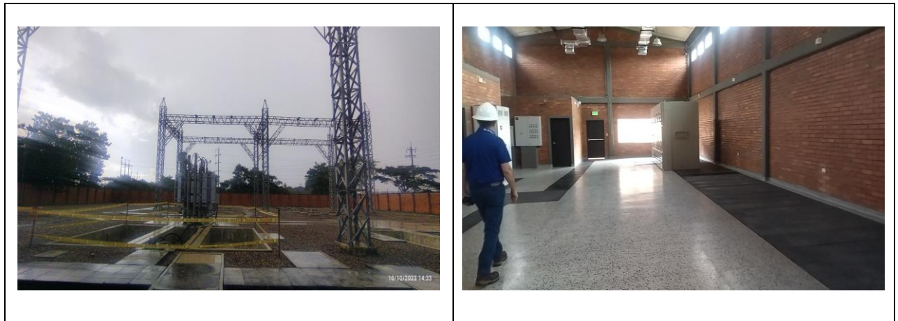
Figura 39. Subestación Playitas 115 kV
