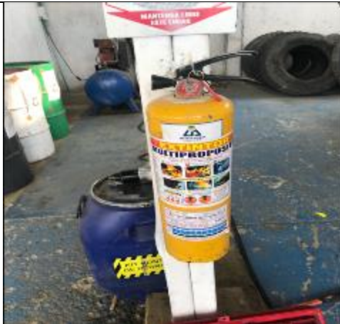
Extintor en área de mantenimiento de vehículos
