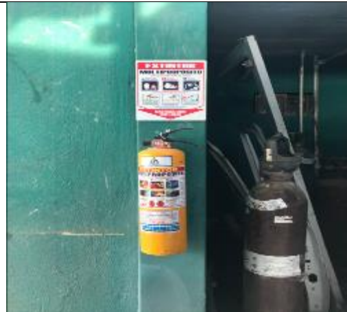
Extintor en áreas de almacenamiento de insumos
