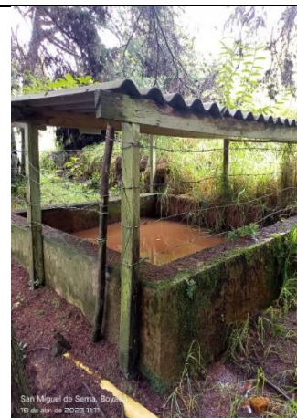
Imagen 61 Tanque de lixiviados
