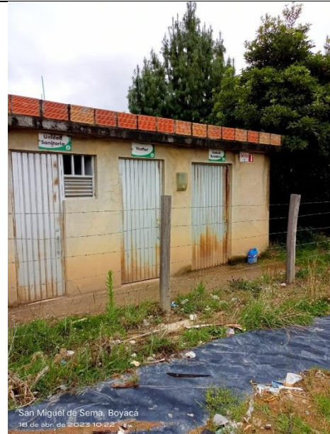
Imagen 72 Área administrativa, vestier, baño y bodegas para residuos aprovechables
