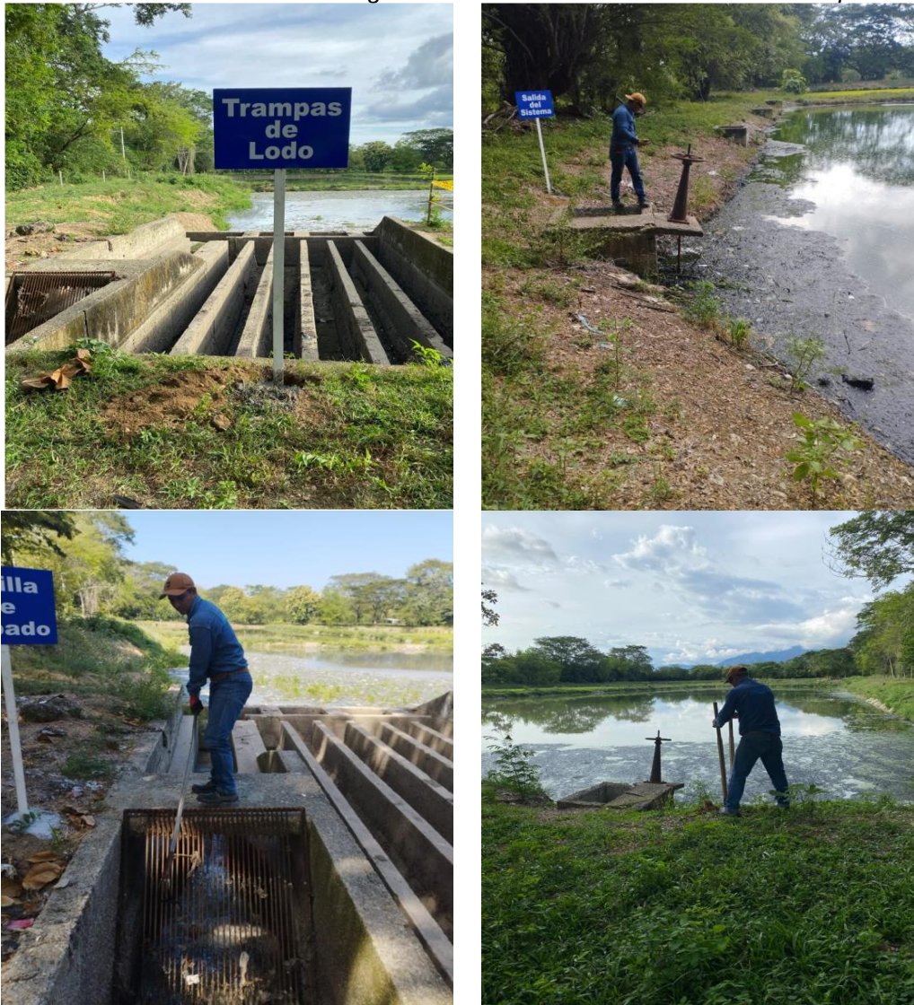
Imagen 27. Sistema de tratamiento de las aguas residuales del casco urbano del Municipio de San Alberto
