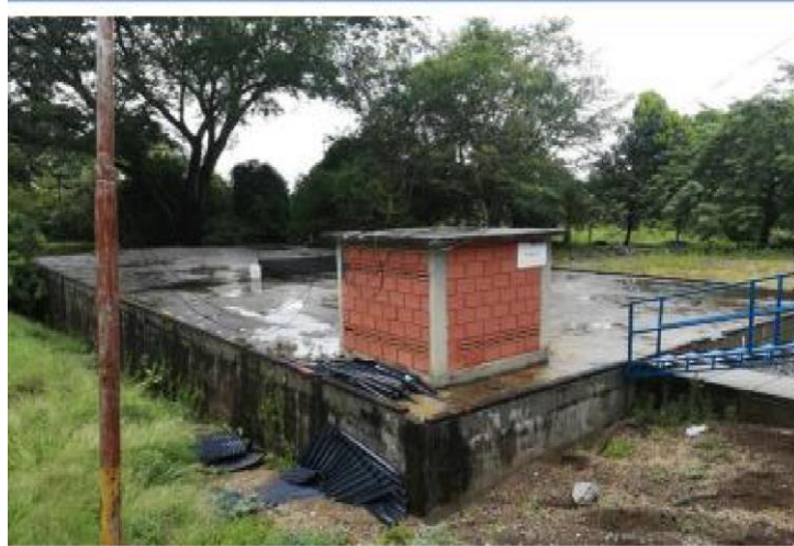
Imagen 15. Tanque de almacenamiento
