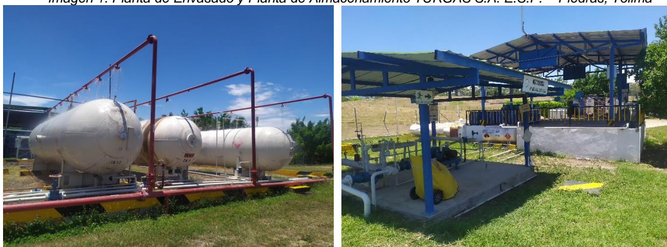
Imagen 1. Planta de Envasado y Planta de Almacenamiento TURGAS S.A. E.S.P. – Piedras, Tolima
