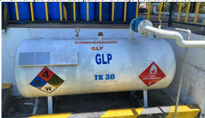
Imagen 3. Tanque destinado para el drenaje (residuo) de los cilindros.
